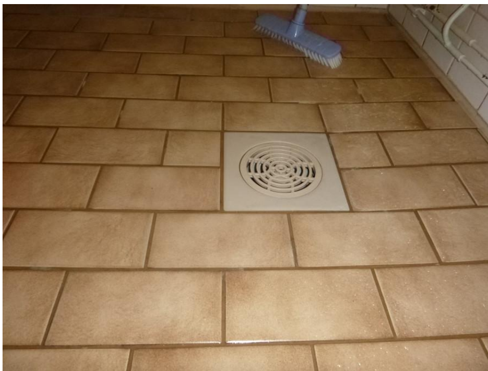
Kuva 44. Märkätilaa oli juuri käytetty. Vedeneristettä ei mitään ilmeisimmin ole. (Petri Ahonen)
