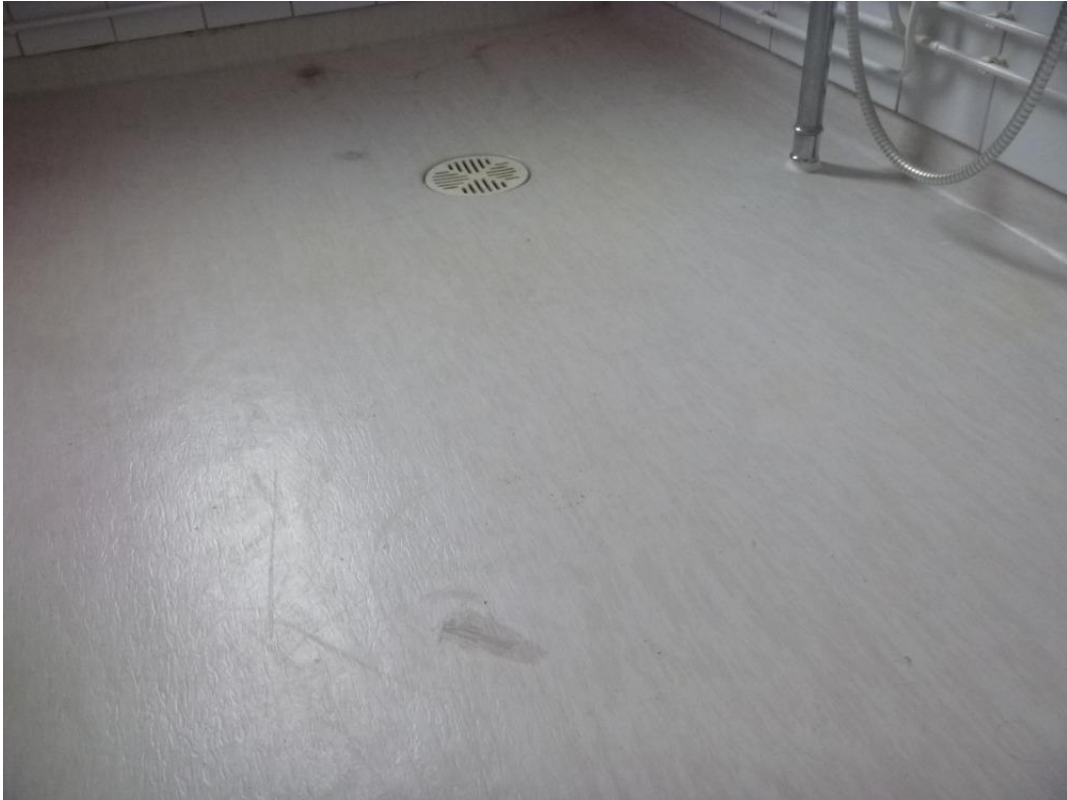
Kuva 29. Pesuhuoneen lattiamatossa on paikkausjälki ja lattian tasoitekerros kopisee.(Petri Ahonen)
