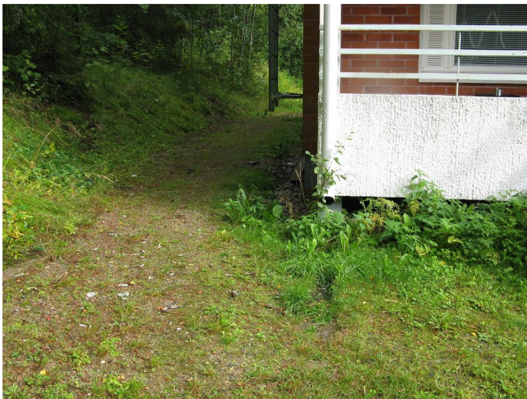
Kuva 4. Maanpinnan kallistukset eivät ole riittävät pohjoispäädyssä.
