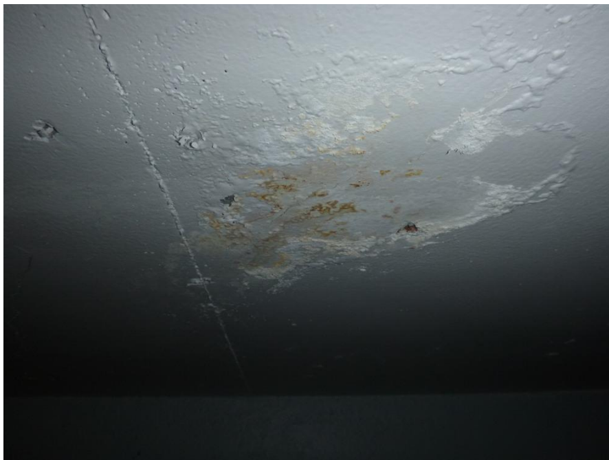
Kuva 28. Käytävän katossa on hiushalkeama, vuotojälki ja kosteutta. Veden syy on vielä varmistamatta.(Petri Ahonen)
