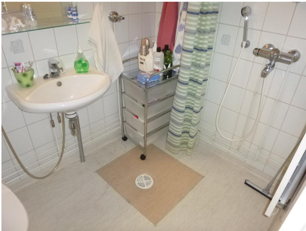
Kuva 32. Lattiamaton pala on uusittu. Lattiakaivon ympärillä mitattiin suurempia kosteusluke- mia, kuin ympäröivässä lattiassa.(Petri Ahonen)
