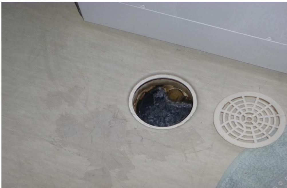
Kuva 36. Pesuhuoneen lattiassa on kosteutta ja mattoa on paikattu. (Petri Ahonen)
