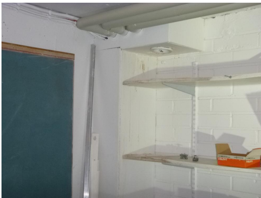
Kuva 26. Kosteusvaurioituneita rakenteita askarteluhuoneessa. (Petri Ahonen)
