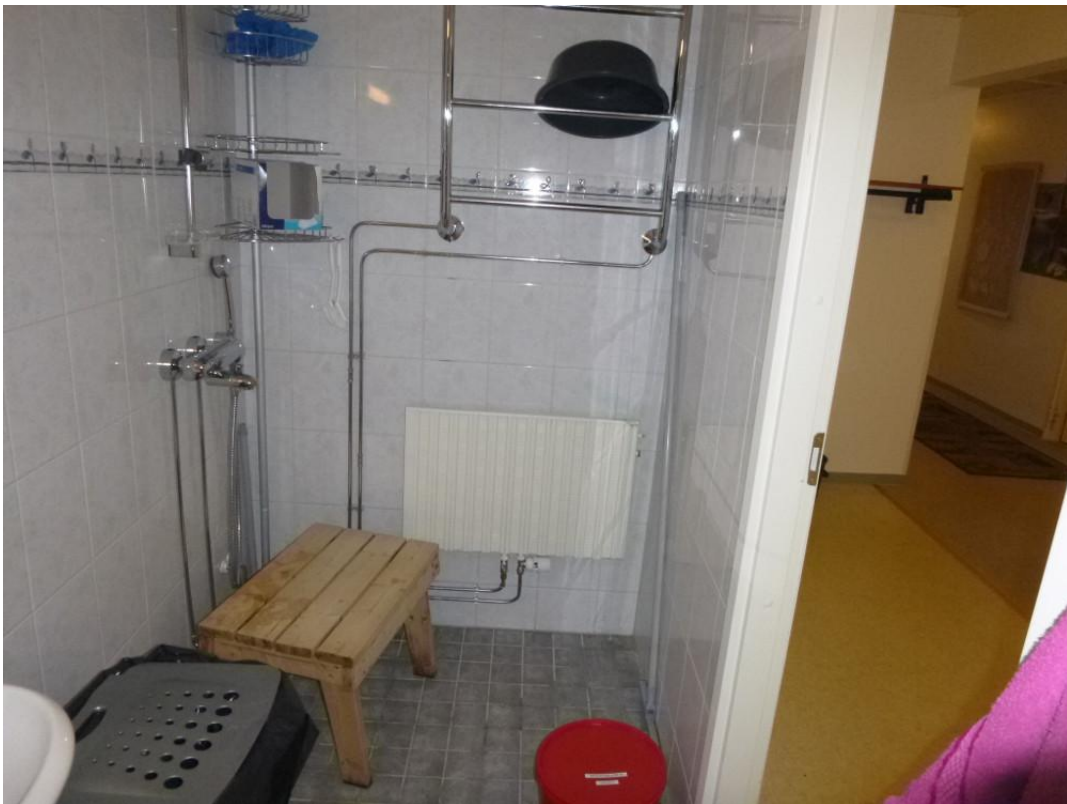
Kuva 40. Rättikuivaimen vuoto on kastellut lattiaa. Kosteus on mahdollisesti laatan ja vesieristeen välissä.(Petri Ahonen)
