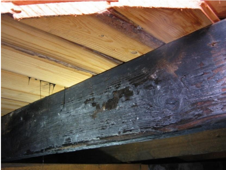
Kuva 21. Yläpohjassa on ollut pienialainen tulipalo edellisen vesikaton aikana. (Petri Ahonen)
