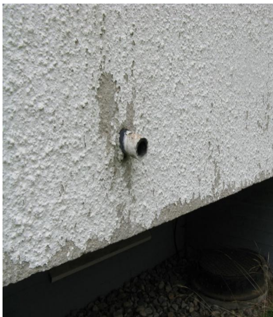
Kuva 15. Asuntojen parvekkeiden rappaus on vaurioitunut (Petri Ahonen).
