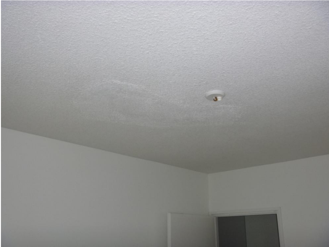
Kuva 39. Asunto 26 katoissa on kaksi vuodon aiheuttamaa jälkeä.(Petri Ahonen)
