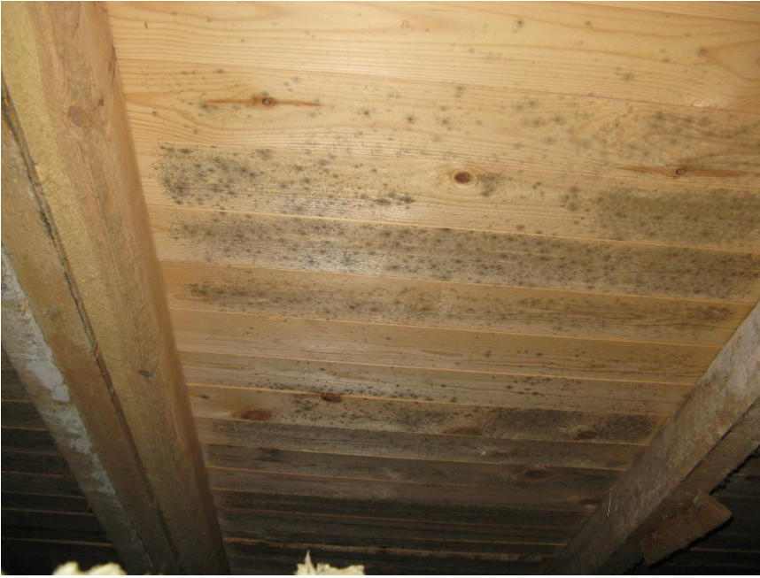
Kuva 18. Tuuletuksen pientä puutetta havaittiin uuden osan eteläpäässä talon keskivaiheella (luukku huippumurin vieressä). Muualla uudella osalla ei havaittu näin selkeitä tummuksia. (Petri Ahonen)
