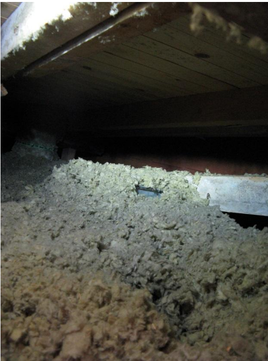
Kuva 19. Yläpohjaan johtava iv-kanavan puhdistusta varten rakennettu vesikaton luukku on noin 2 m väärässä paikassa. Kuvassa näkyy nuohoamaton iv-kanavan luukku. Tämä luukku sijaitsee lähellä huippumuria uuden ja vanhemman osan liitoksen lähellä. (Petri Ahonen)
