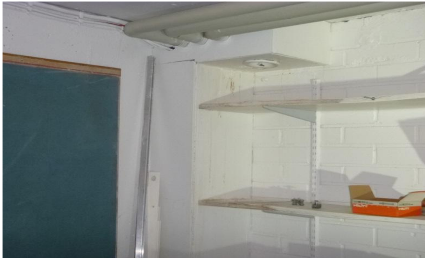
Kuva 52. Askarteluhuoneen vesivaurio. (Petri Ahonen)
