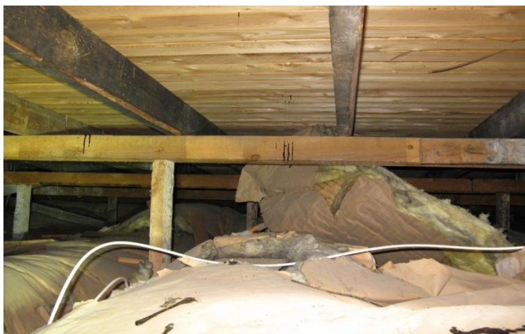
Kuva 57. Yläpohjassa vanhalla osalla ilmanvaihtokanavien eristykset ovat paikoin tummuneet. Tummuminen voi olla seurausta kanaviston ilmavuodoista. (Petri Ahonen)
