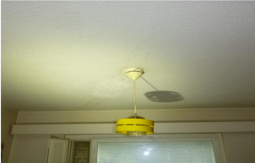
Kuva 42. Olohuoneen katossa on poikkeuksellinen jälki. Asunnossa on tupakoitu. (Petri Ahonen)
