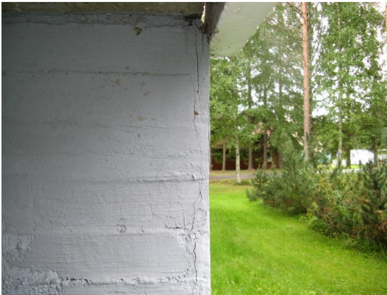
Kuva 14. Halkeama parvekkeen alla kantavassa seinäkkeessä. (Petri Ahonen)
