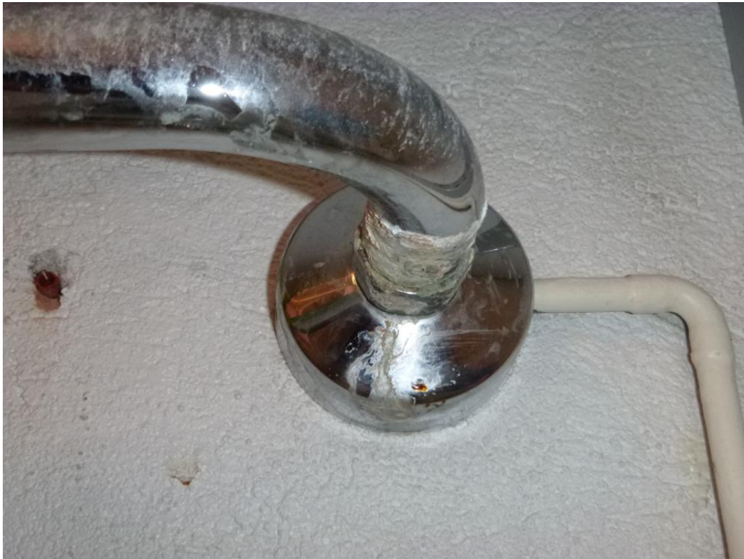
Kuva 50. Rättikuivaimessa on vuotojälki B-rapun siivouskomerossa. (Petri Ahonen)
