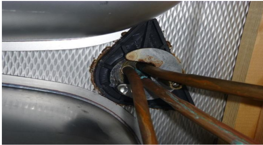
Kuva 49. Vuoto asunto 14 keittiön allaskaapissa. (Petri Ahonen)
