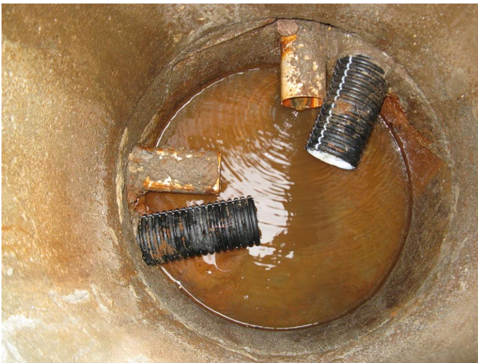
Kuva 11. Tarkastuskaivo etupihalla p-päädyssä. Kaivon sakkapesä on täynnä kiintoainetta. Mitä ilmeisimmin uudemman näköiset putket on myöhemmin asennettu kellarin kuivattamiseksi? (Petri Ahonen)
