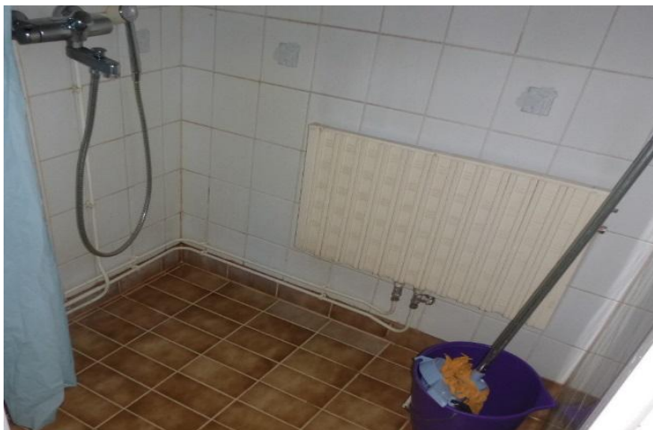
Kuva 47. Asuntojen märkätiloissa on alkuperäiset lämmityspatterit.(Petri Ahonen)
