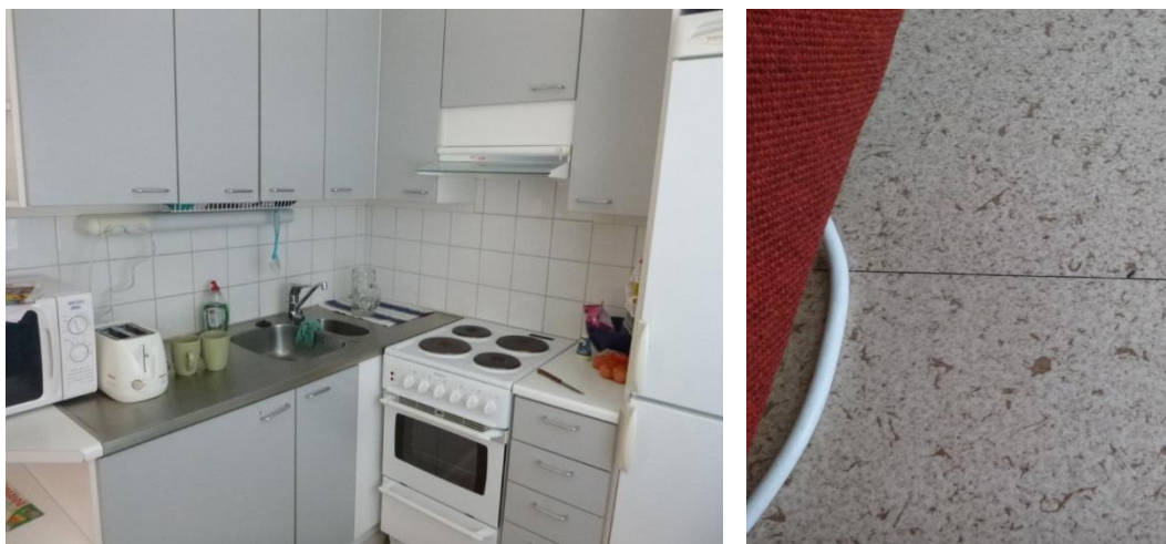
Kuvat 30 ja 31. As 6 keittiö ja kuivien tilojen muovimatto. (Petri Ahonen)
