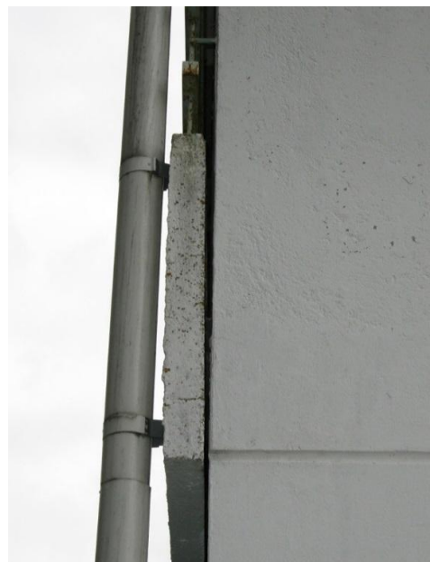
Kuva 16. Parvekkeen seinäkkeitä on notkahtanut.(Petri Ahonen)
