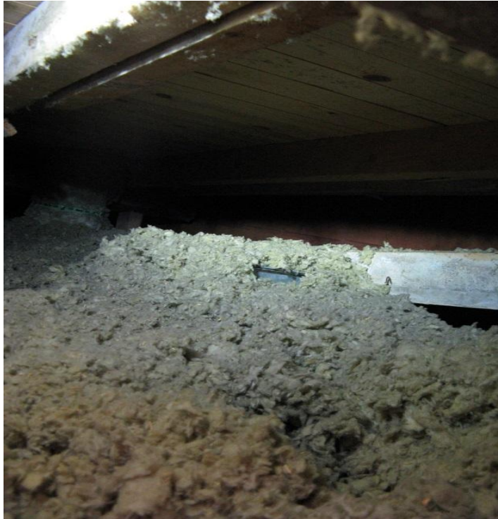
Kuva 56. Talon uudella osalla yläpohjassa huippumurin vieressä sijaitseva ilmanvaihdon puhdistusluukku on nuohoojan painajainen, koska kattoluukku on rakennettu noin 2 m väärään paikkaan. Kanava on jätetty tästä kautta nuohoamatta vuonna 1996. (Kiinteistön huolto) (Petri Ahonen)
