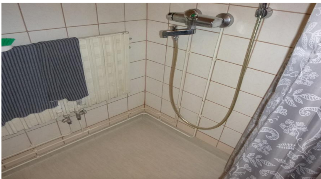
Kuva 33. Asunto 20 vanha seinälaatoitus on uusimisen tarpeessa vähintään "kopo"-laattojen osalta. (Petri Ahonen)
