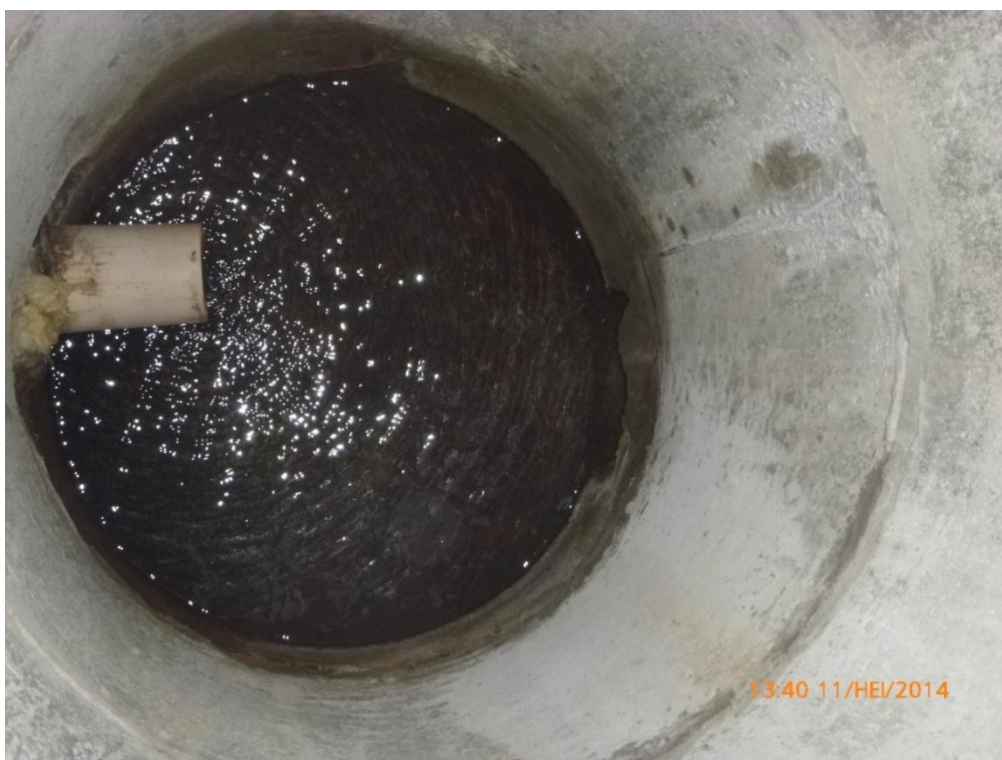
Kuva 9. Takapihan tarkastuskaivossa on vettä putkien puoleenväliin saakka. (Petri Ahonen)
