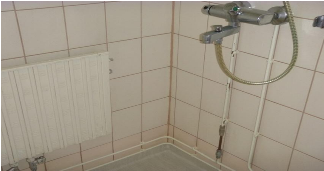
Kuva 34. Asunto 21 pesuhuoneen laatoitus on ylittänyt teknisen käyttöikänsä. (Petri Ahonen)
