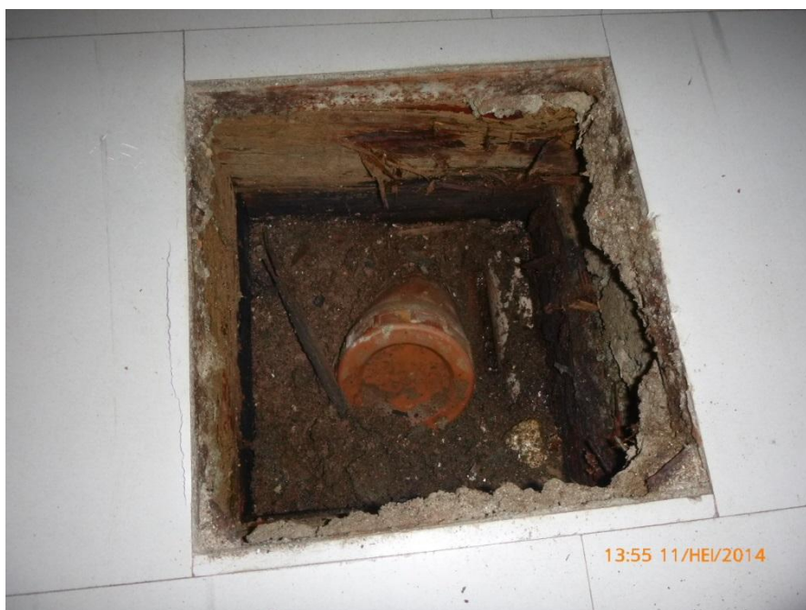
Kuva 27. Viemärin tarkastusluukku on puurakenteinen. Hiekassa on vettä. (Petri Ahonen)
