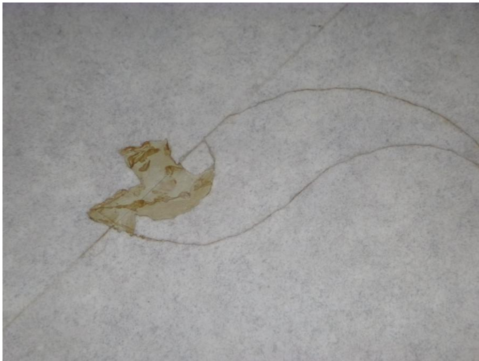
Kuva 35. Olohuoneen lattiamatto on rikkoutunut. (Petri Ahonen)
