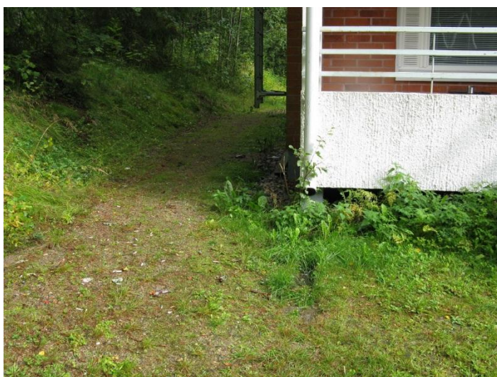
Kuva 12. Takapihalla syöksytorvesta tuleva vesi jää seisomaan rakennuksen nurkalle. (Petri Ahonen)
