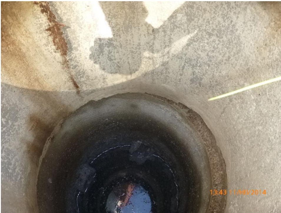
Kuva 7. Salaojakaivon rengas on siirtynyt eteläpäädyssä. Putket ovat betonista ruukkuputkea. (Petri Ahonen)
