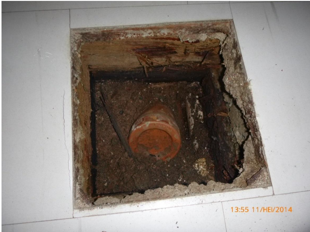
Kuva 51. Jätevesiviemärin ympäröivä hiekka on märkää. (Petri Ahonen)
