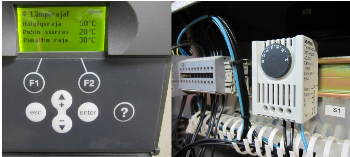
Kuva 23. Nokian Capacitors -kompensointilaitteistojen lämpötilan säätö. Kuvassa vasemmalla on sisäinen ja oikealla ulkoinen termostaatti.
