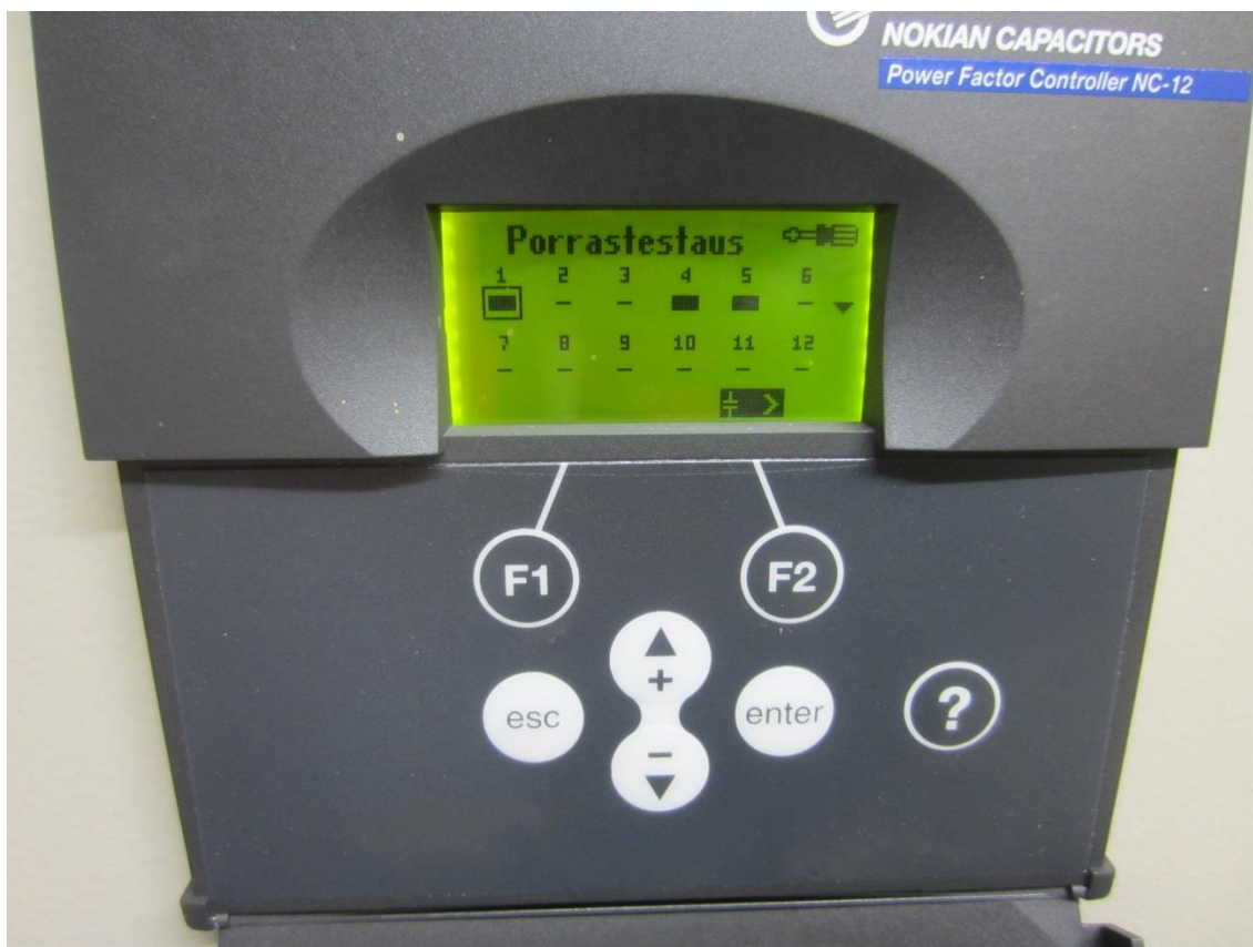
Kuva 19. Nokian Capacitorsin NC-12-säätimellä pystyy testaamaan manuaalisesti yhden halutun portaan kerrallaan.
