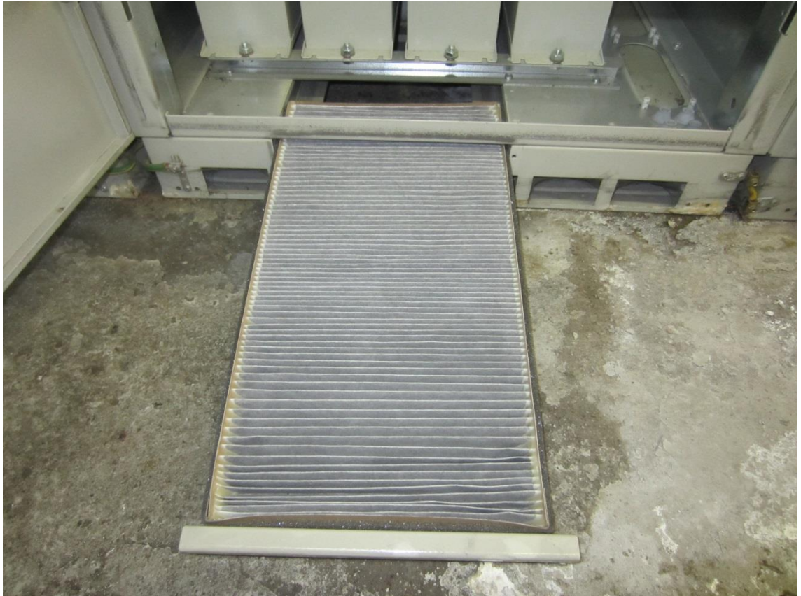
Kuva 22. Nokian Capacitorsin uusimmissa kompensointilaitteistoissa suodattimen vaihto onnistuu ilman kannen avausta, jolloin jännitteiset osat eivät tule näkyviin.
