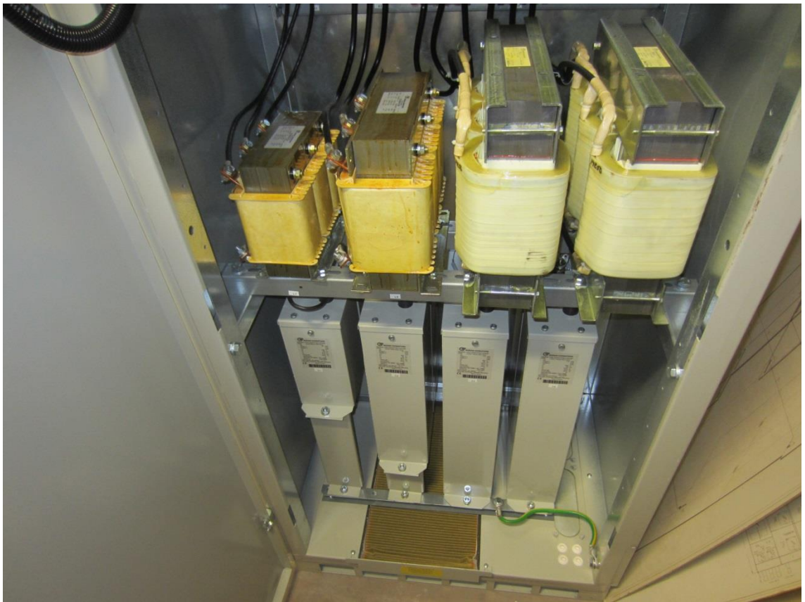
Kuva 7. Kuvassa Nokian Capacitors D225 -estokelaparisto, jossa näkyy portaiden kelan ja pariston muodostama sarjakytkentä.
