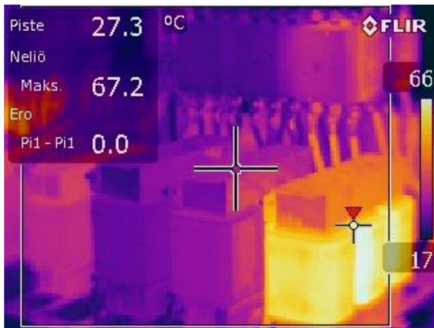
Kuva 15. Lämpökamera on hyvä työkalu mahdollisten löysien liitosten etsimiseen.
