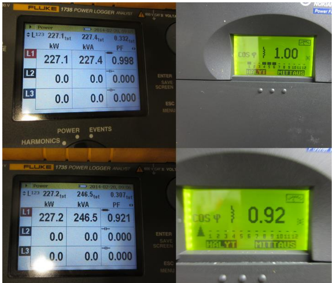
Kuva 21. Nokian Capacitors NC-12 -säätimen tehokerroin on varmistettu analysaattorilla. Ylempänä 37,5 kvarin paristo ja 3 kpl 75 kvarin paristoja on kytketty verkkoon, alempana verkkoon ei ole kytketty paristoja.
