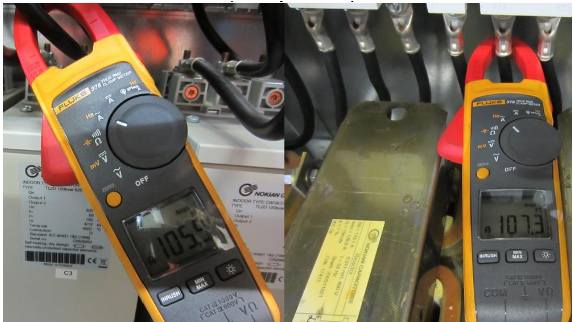
Kuva 17. Nokian Capacitorsin 75 kvarin pariston virtamittaus vasemmalla pariston ja estokelan välistä ja oikealla kontaktorin ja estokelan välistä.
