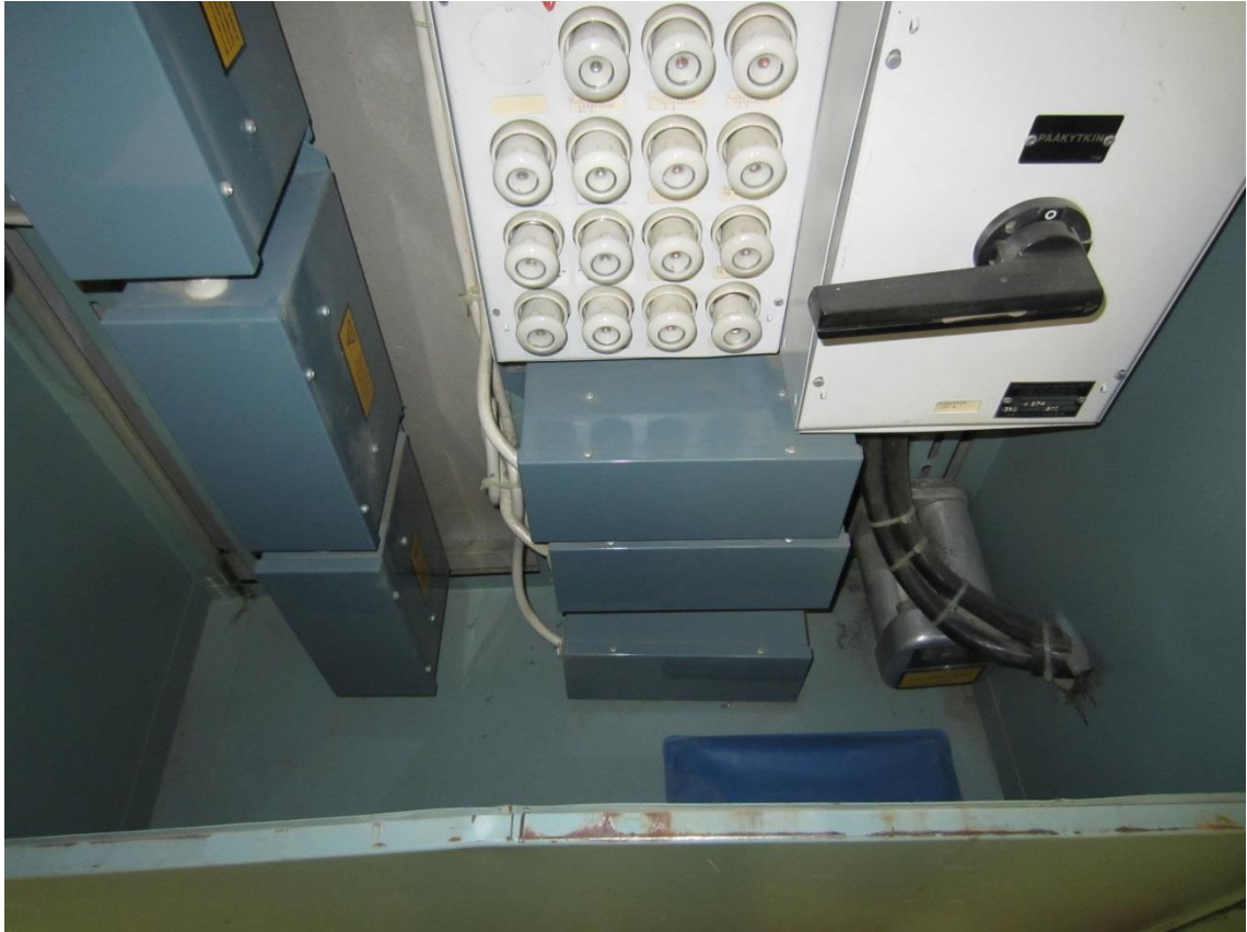
Kuva 5. Ryhmäkeskuksessa kiinteitä kompensointiparistoja, jotka oli asennettu purkauslampuvalaistuksen rinnalle. Valaistuksen uusimisen jälkeen paristot eivät olleet enää tarpeen paremman hyötysuhteen vuoksi, jolloin niiden kytkentä purettiin.
