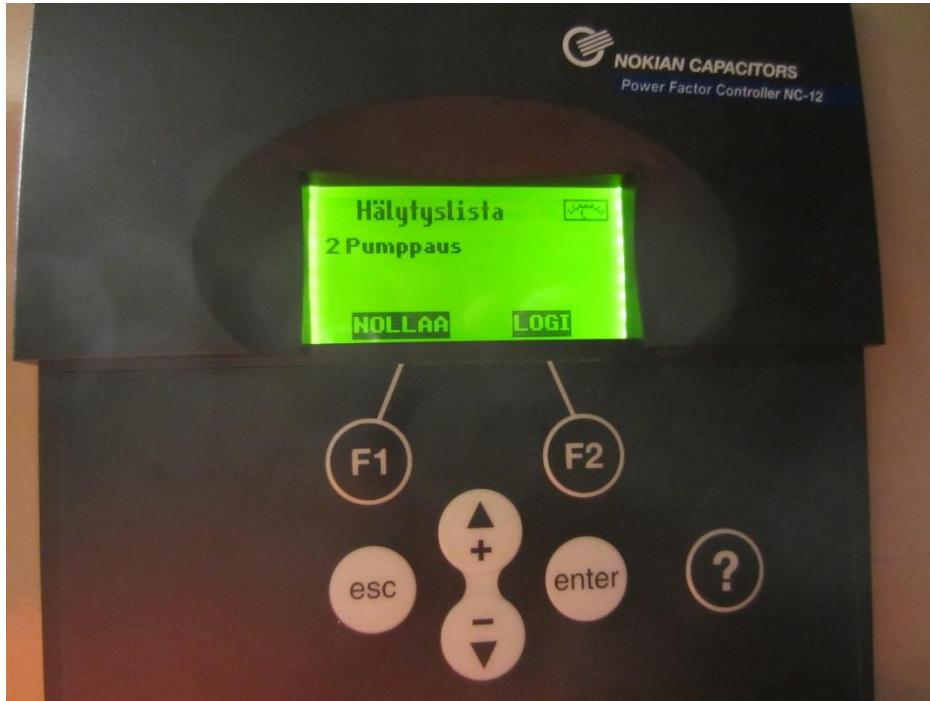
Kuva 25. Nokian Capacitors NC-12 -loistehosäädin, jossa on aktiivinen pumppaushälytys. Syyinä oli liian pieni induktiivinen havahtumisraja.
