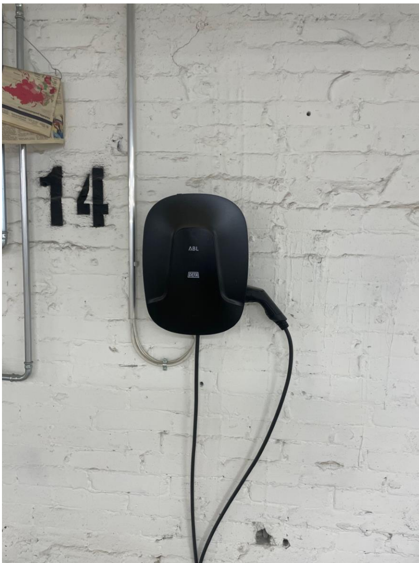
Kuva 11. Kiinteistössä sijaitseva auton latausmittari.
