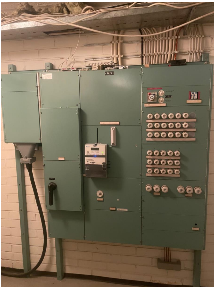
Kuva 9. Kiinteistössä sijaitseva sähköpääkeskus.
