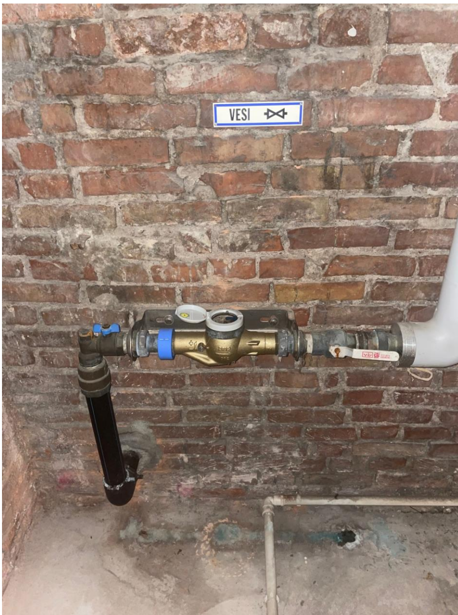
Kuva 5. Kiinteistössä sijaitseva vesimittari. Kohde on merkitty seinässä olevalla kyltillä.
