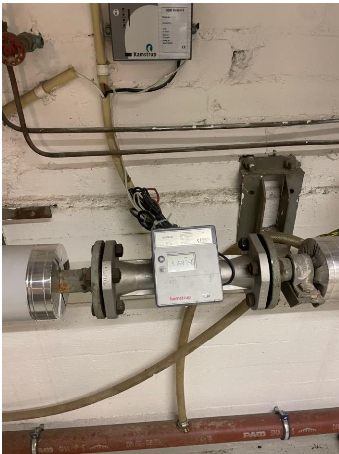
Kuva 7. Kiinteistössä sijaitseva kaukolämpö ja -kylmämittari.
