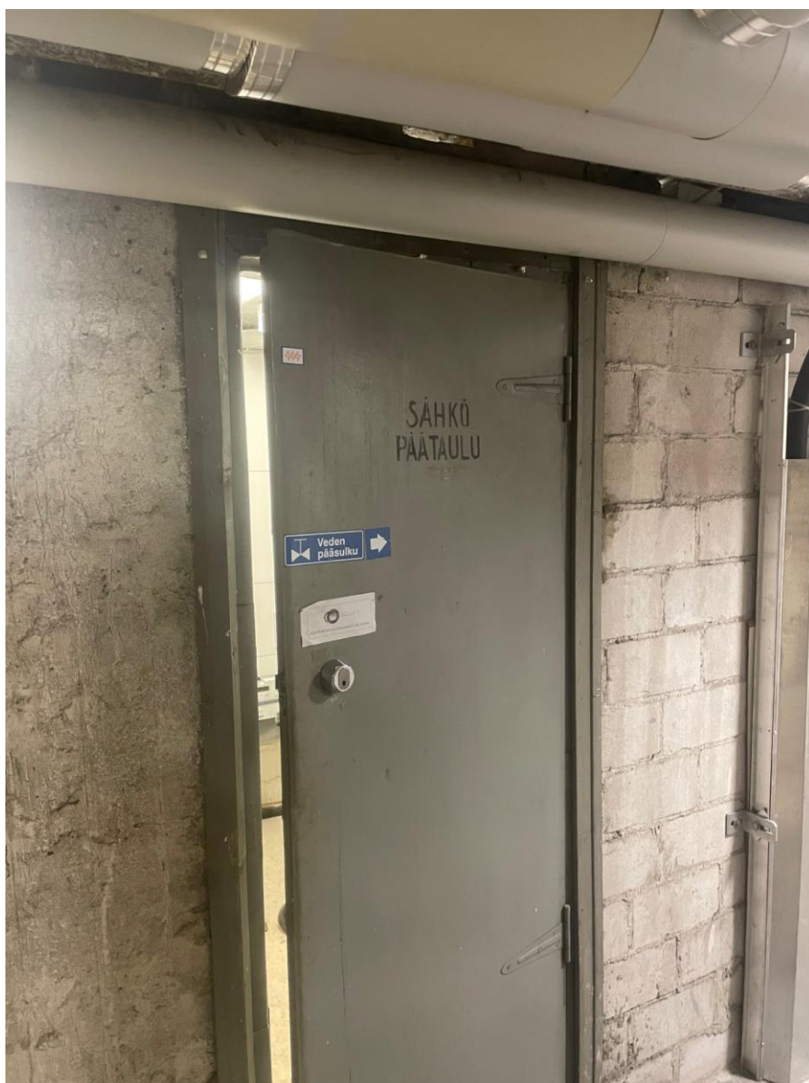
Kuva 14. Kohdekierroksen aikana mustalla tussilla tehty korjausmerkintä: SÄHKÖ PÄÄTAULU kohteen oveen.
