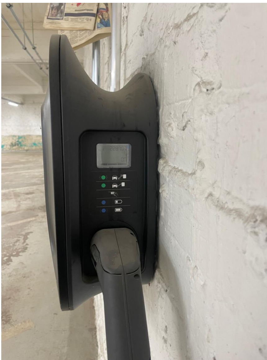
Kuva 12. Kiinteistössä sijaitseva digitaalinen auton latausmittari.
