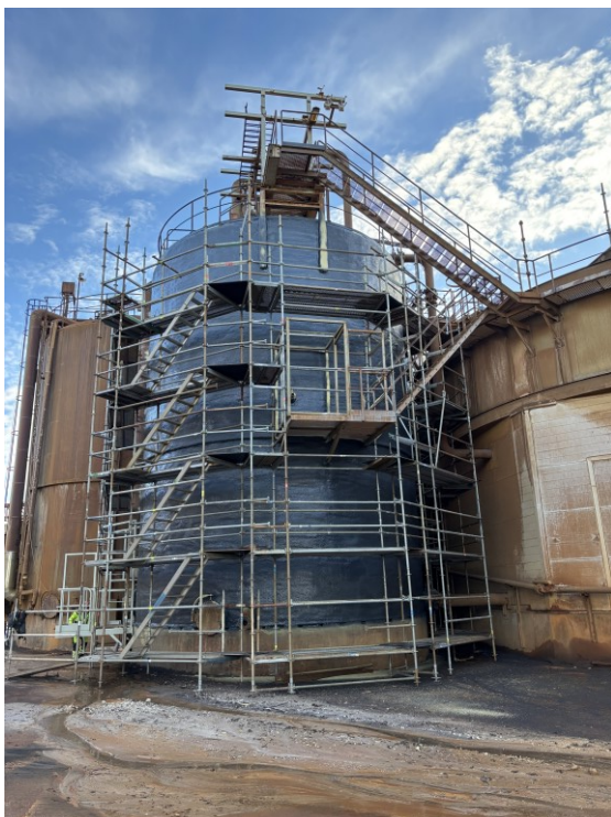
Kuva 7. Polyuretaanilla eristetty reaktori.
