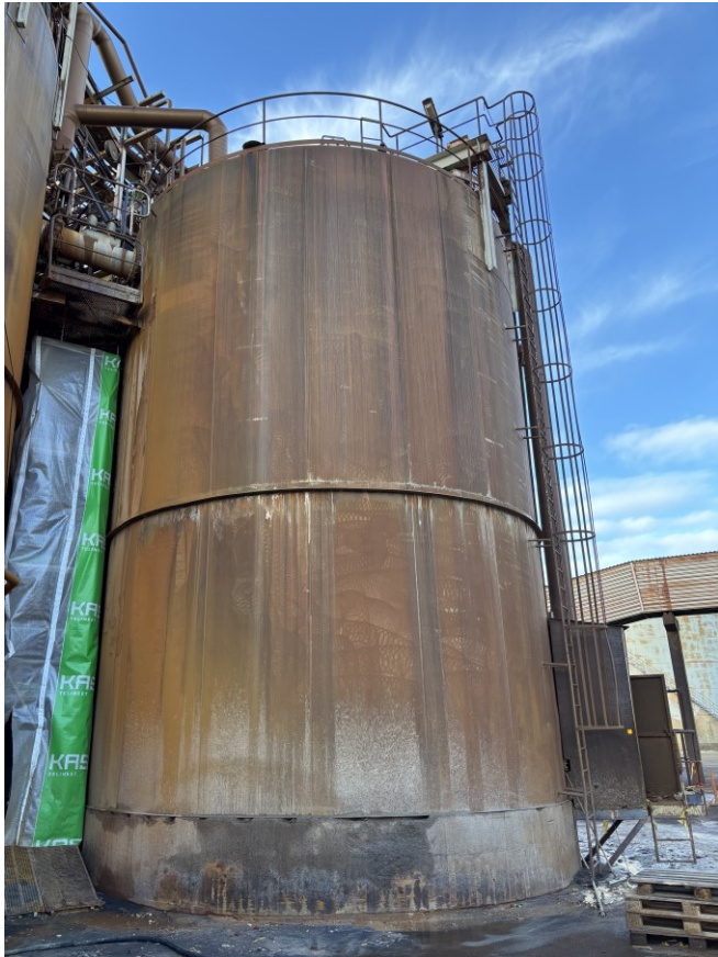
Kuva 2. Kaanaan jätevedenpuhdistamon eristämätön neutralointireaktori.
