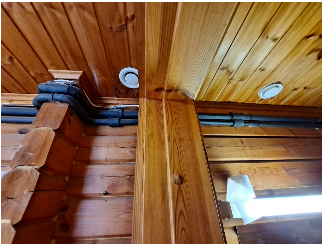
Kuva 4. Pukuhuoneen ja Wc-tilan poistoilmaventtiilejä.
