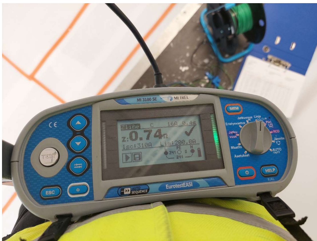
Kuva 4. Syötön automaattisen poiskytkennän mittaus käynnissä.
