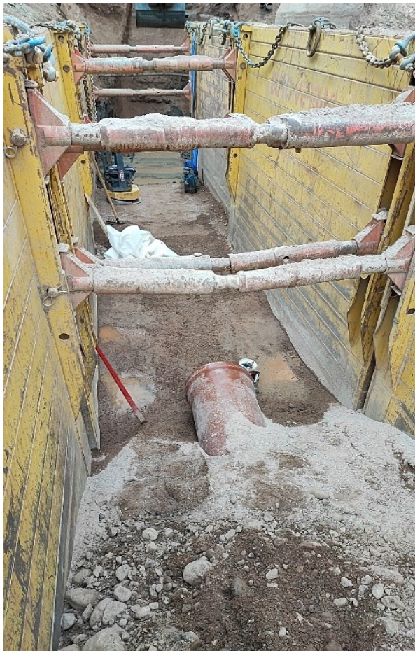
Kuva 2. Kaivannon pohja on märkä.
