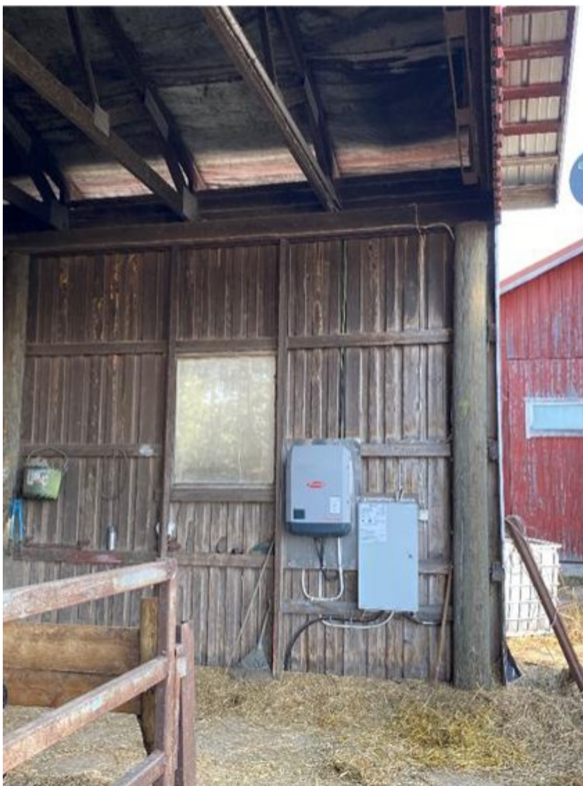
KUVA 2. Vaihtosuuntaajan asennus palovaarallisessa ympäristössä ja on eläimien kosketeltavissa. (TUKES 2023, Liite 2).
