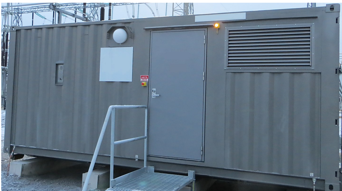
KUVA 4. Sähkölaitteisto teollisuuskontissa ja perustuksille asennettuna
