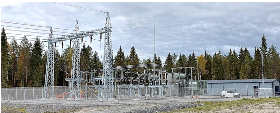
KUVA 1. 110/33 kV sähköasema hajautetun tuotannon liittämistä varten
