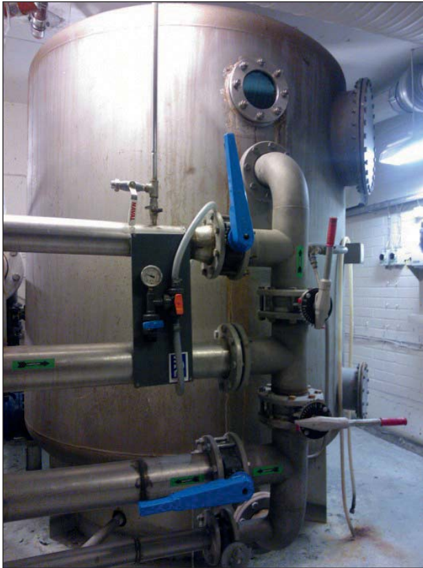
KUVA 2. Uimaveden puhdistuskierron hiekkasuodatus (kuva Hannu Poutiainen)
