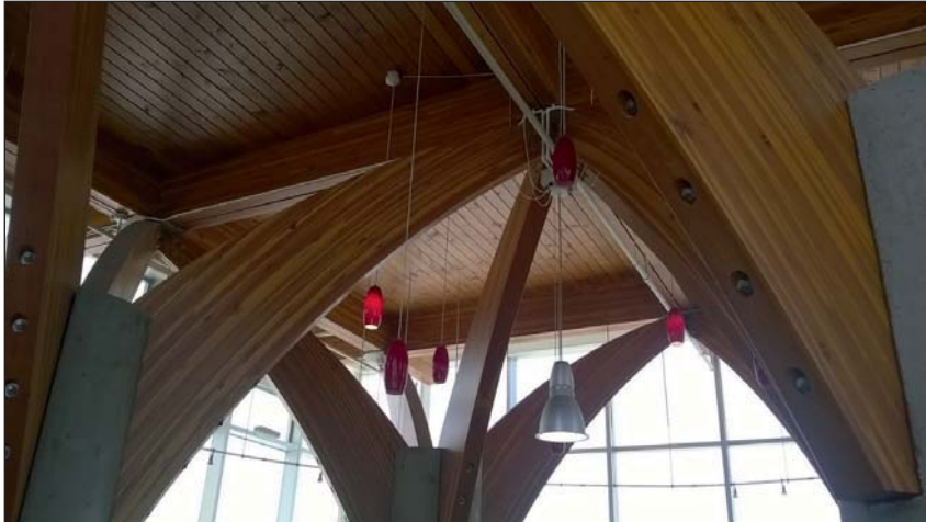
KUVA 2. Puinen kattorakennelma. Vancouver Kanada (kuva Jussi Levonen)
