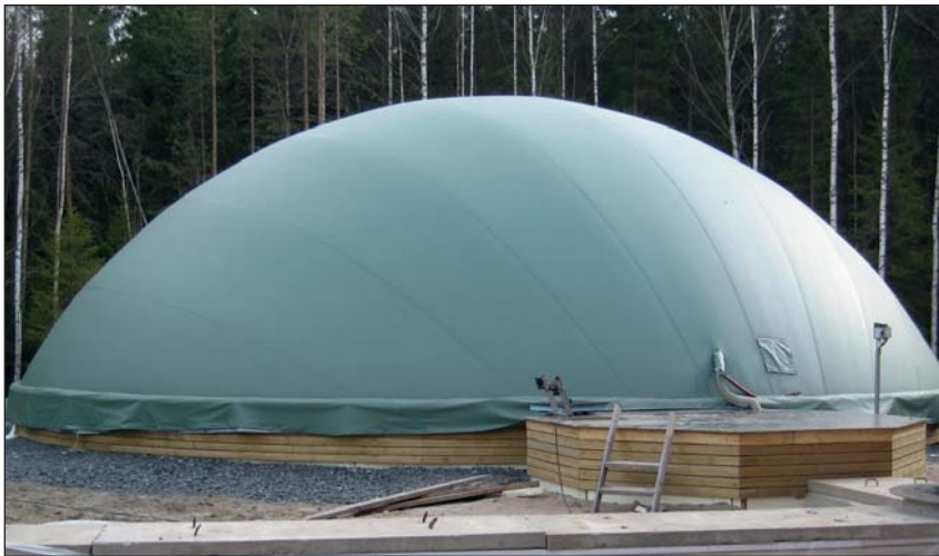
KUVA 3. Primäärireaktorin maanpäällinen osa, kaasukello, toimii myös kaasuvaramona (kuva Hanne Soininen)
