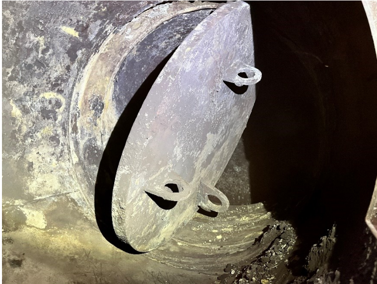
Kuva 9. Kuvan 8 venttiili putken sisältä kuvattuna.
