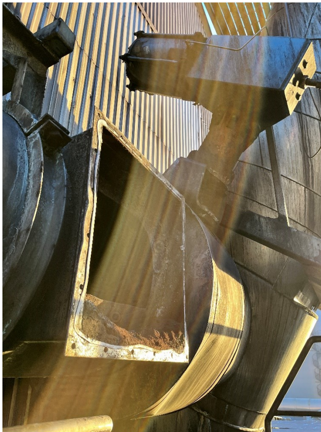
Kuva 8. Valmet pneumaattinen toimilaite ja venttiilin tarkastusluukku.
