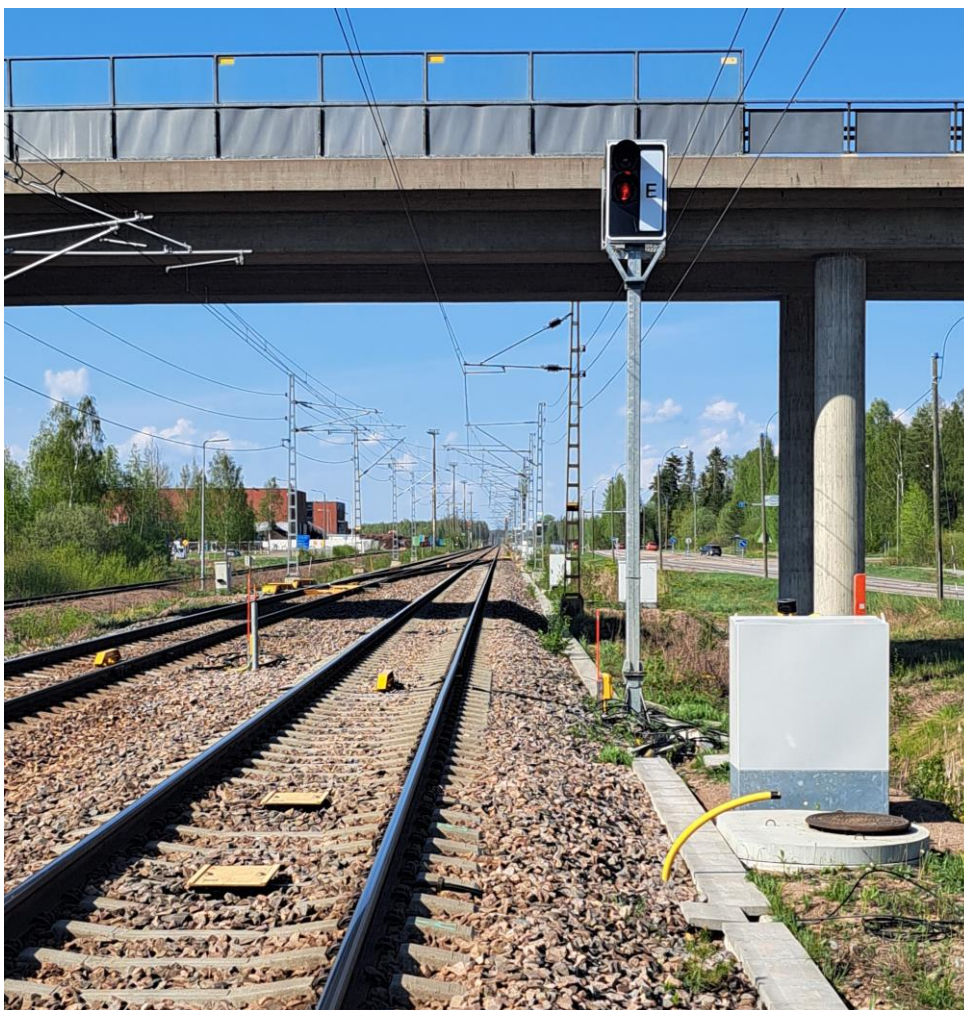
Kuva 11. Opastin tunnuksella E, kaapelikanava, kaapelikaivo ja turvalaitekaappi radan oikealla puolella. Baliisit radan keskellä.
