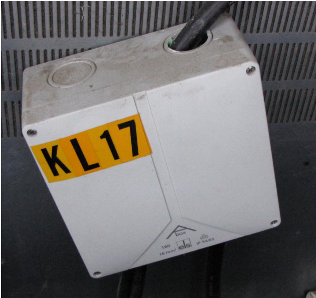
Kuvio e. Jakopaikka muuntamossa sijaitsevassa rasiassa
