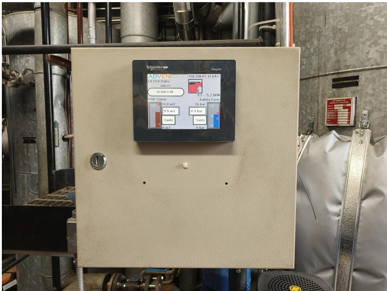
Kuva 8. Uusi Schneider Electricin Magelis-sarjan HMI-paneeli (HMIS5T) asennettuna keskuksen oveen upotettuna LK159:llä.
