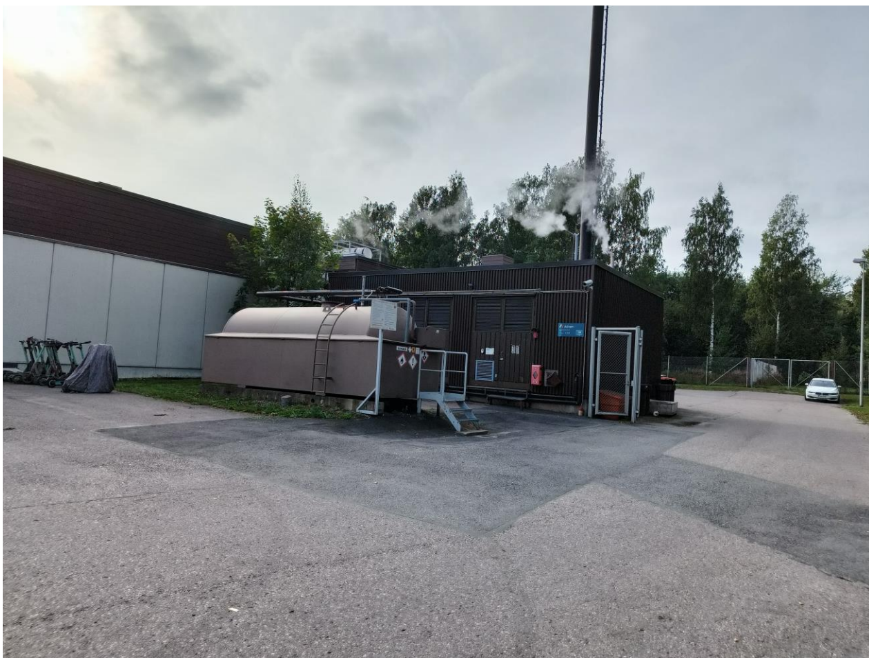
Kuva 3. LK159 ulkoapäin, edessä näkyy säiliö, jossa on polttoöljyä, joka toimii höyrykattilan polttoaineena sekä sen takana sijaitsee itse lämpölaitos.
