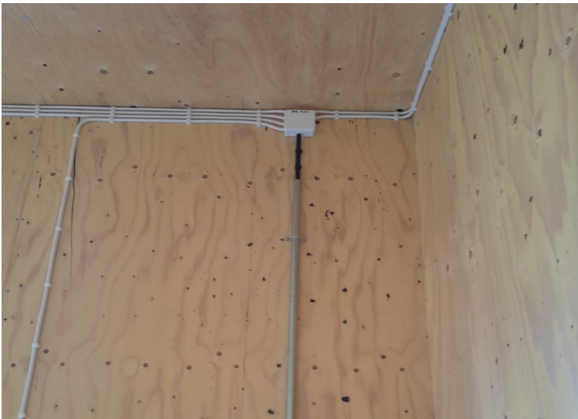
KUVA 4. Mallikkaasti toteutetut pinta-asennukset ulkovarastossa
