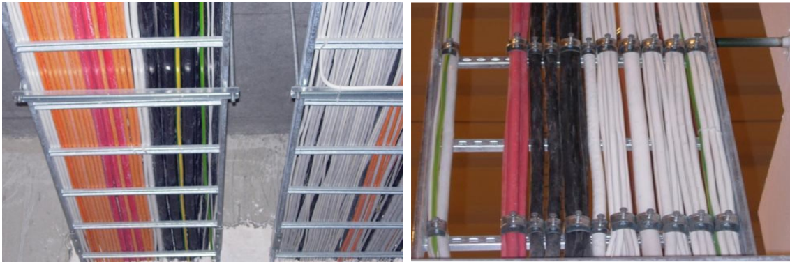
KUVA 3. Mallikkaasti asennetut kaapelit vaakahyllyille ja asianmukaisesti poolatut pystyhyllyn kaapelit (30, s. 1)
