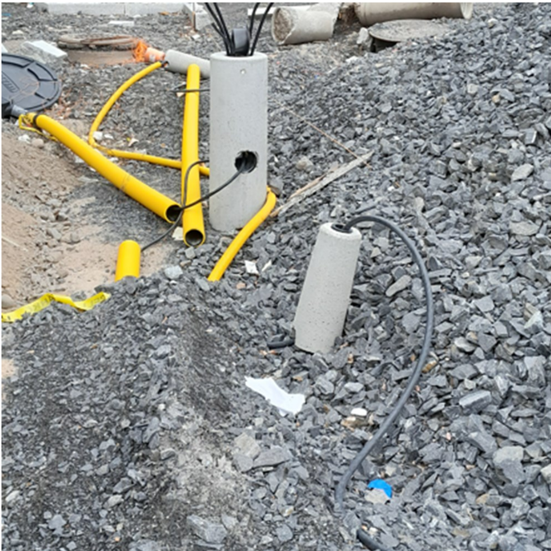
KUVA 6. Virheellisesti murskeen sekaan asennettuja kaapeleita ja suoja-putkia
