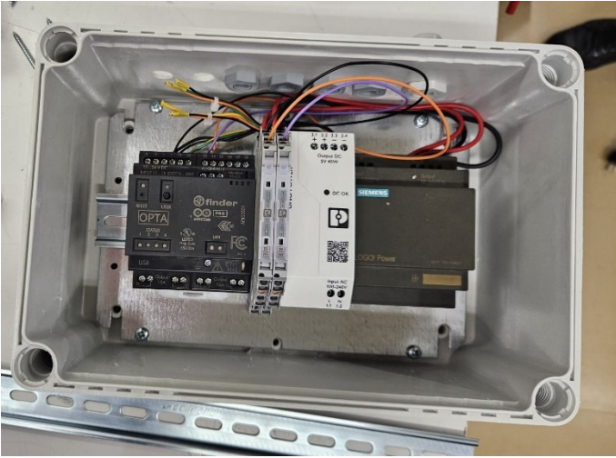
KUVA 11. Tarvittavien koejien asettelu asennuskoteloon.
