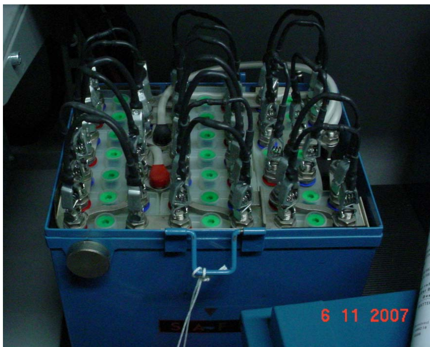
Kuva 2. Saft-akku (osanumeroltaan 23491) avattuna, kuvassa myös nähtävillä ta-sausvastuksia
