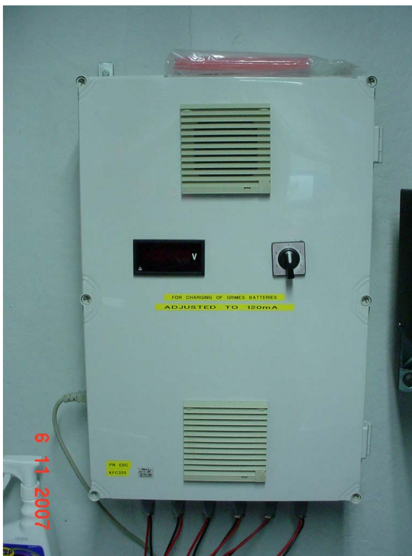
Kuva 9 Laturi osanumeroltaan EBC, tätä yksilöä käytetään huolloissa
