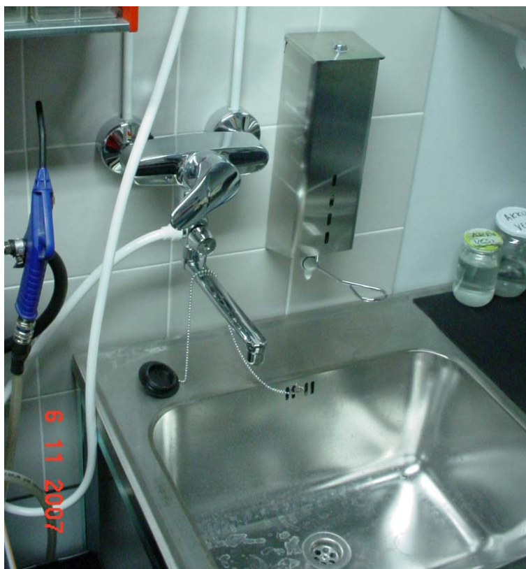
Kuva 14 Käsienpesuallas korjaamon seinällä
