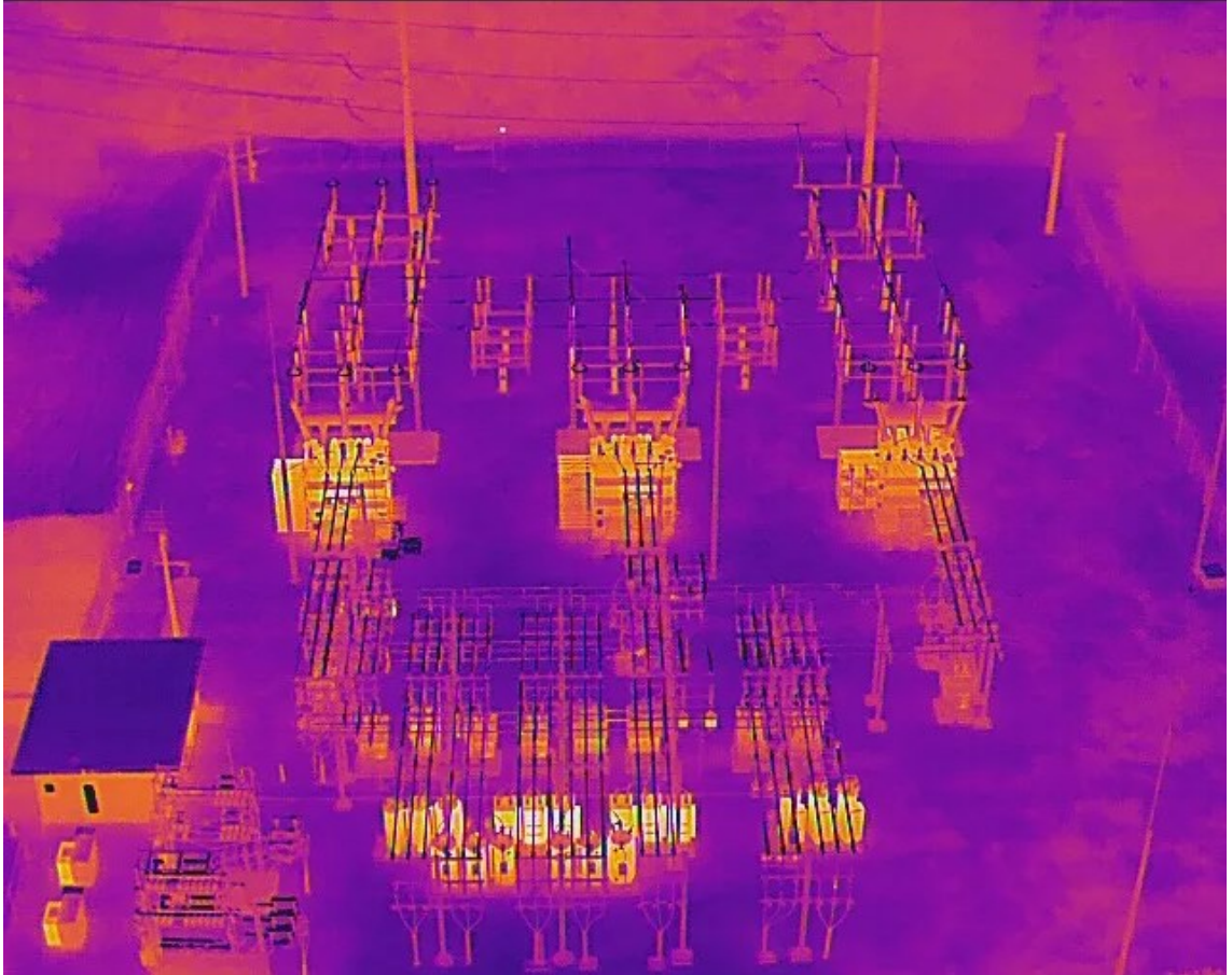
Kuvio 7. Sähköaseman yläpuolelta otettu lämpökamerakuva dronen avulla, jossa pystytään saamaan kokonaisvaltainen kuva muuntajien ja reaktoreiden lämpötiloista (UAV Miami 2024).
