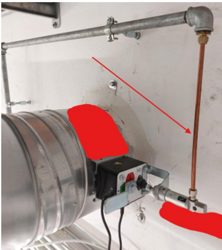
Kuva 14. UV-laitoksen FDMR-pneumaattinen palopelti.
