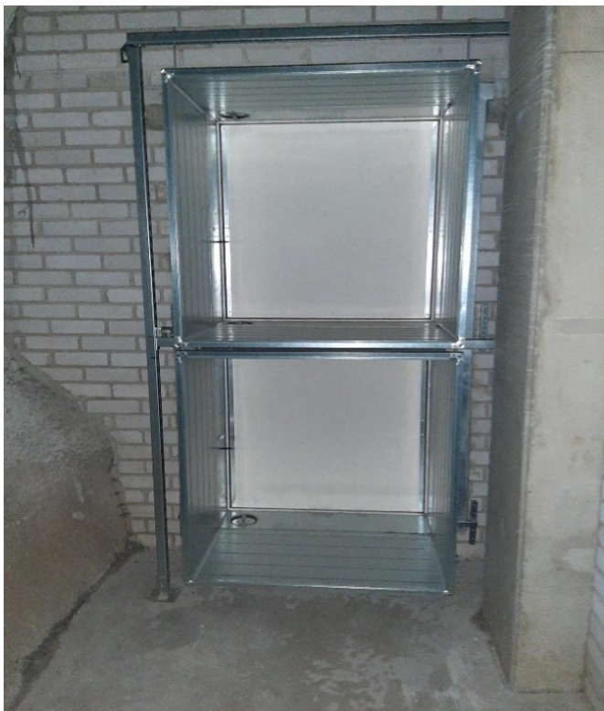
Kuva 12. Poistoilmakammiossa sijaitsevat FDMA-S-palopellit.
