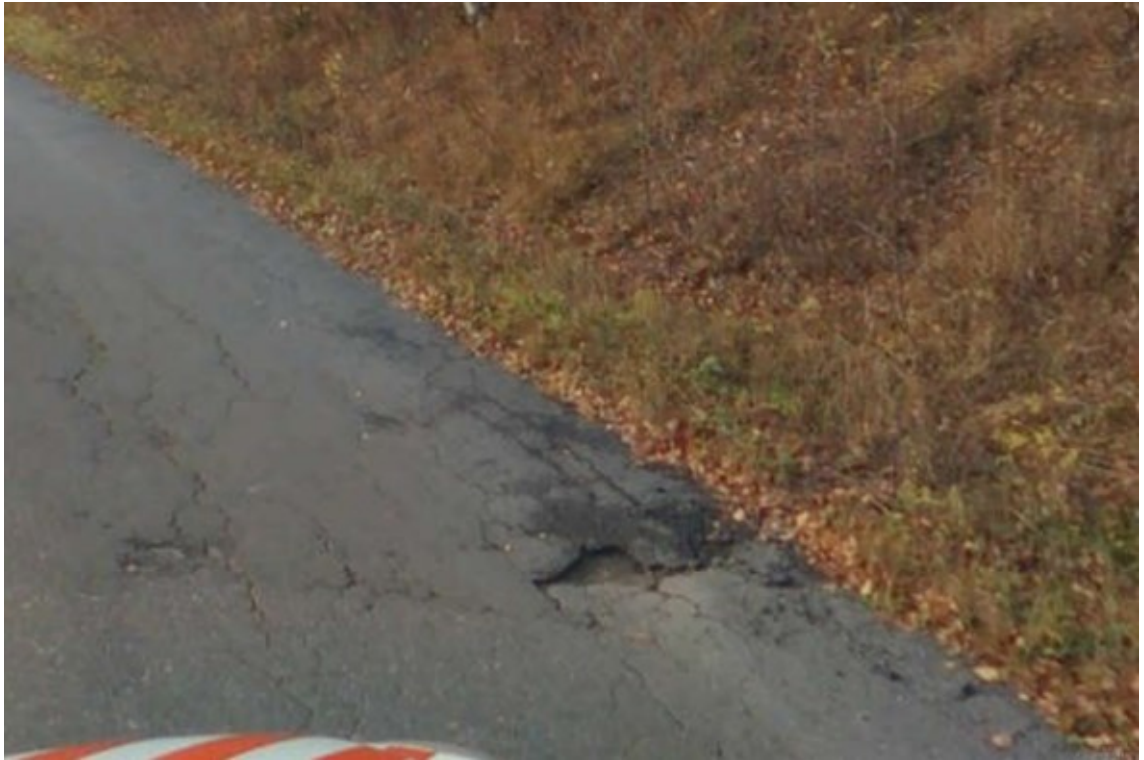
Kuva 9. Muut vauriot vaurioluokka 1
