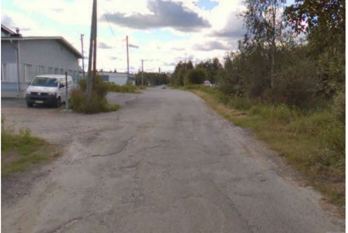
Kuva 11. Muut vauriot vaurioluokka 3
