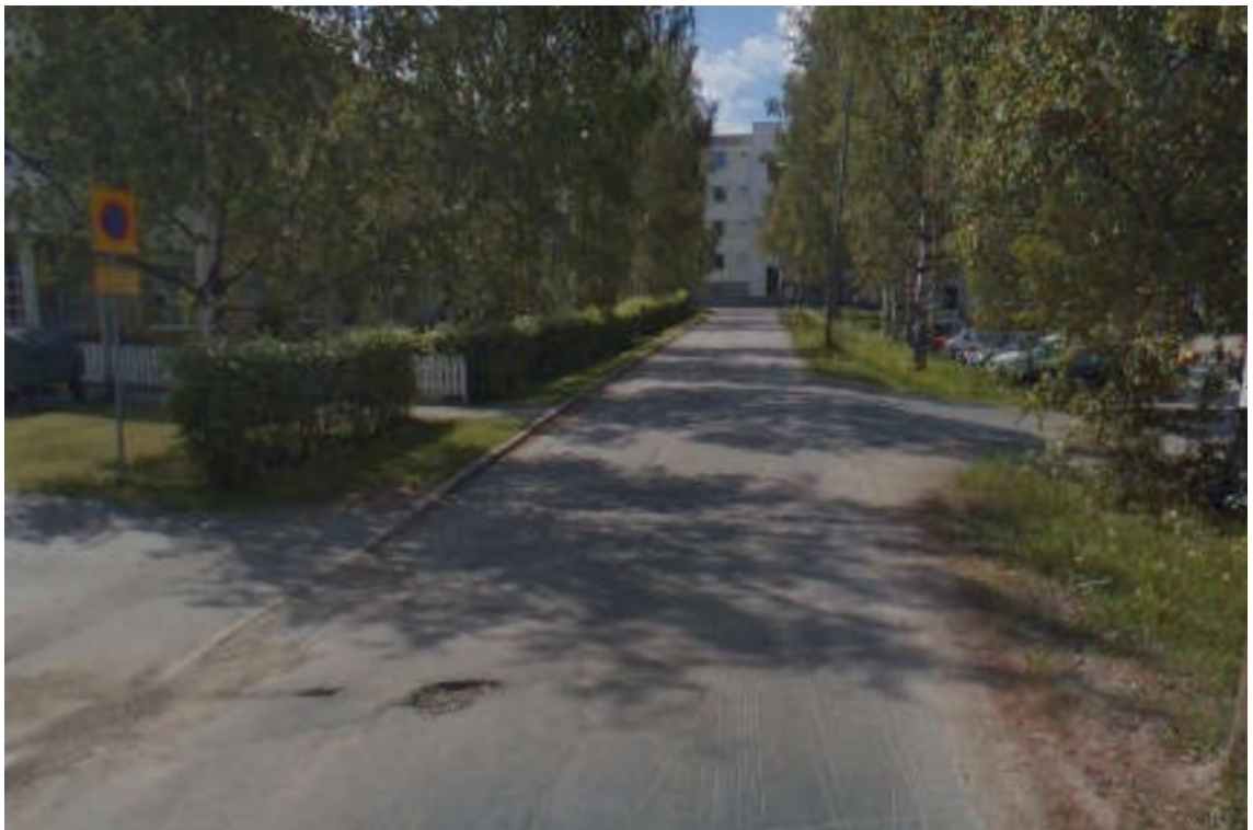
Kuva 10. Muut vauriot vaurioluokka 2
