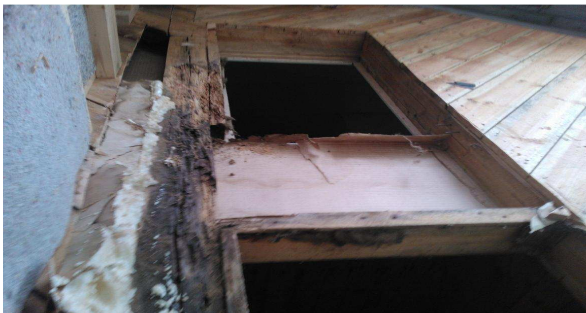
Kuva 9. Vanhan laajennusosan aiheuttamaa lahovauriota ( Sepponen 2014 )
