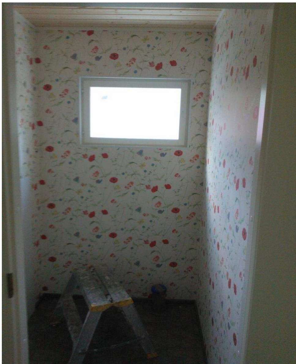
Kuva 12. Wc:n seinää ja lattiaa (Sepponen 2014)
