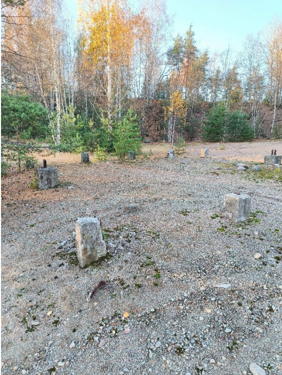
Kuva 23. Torttilan maanotto paikalta löytyneet betoniperustukset.
