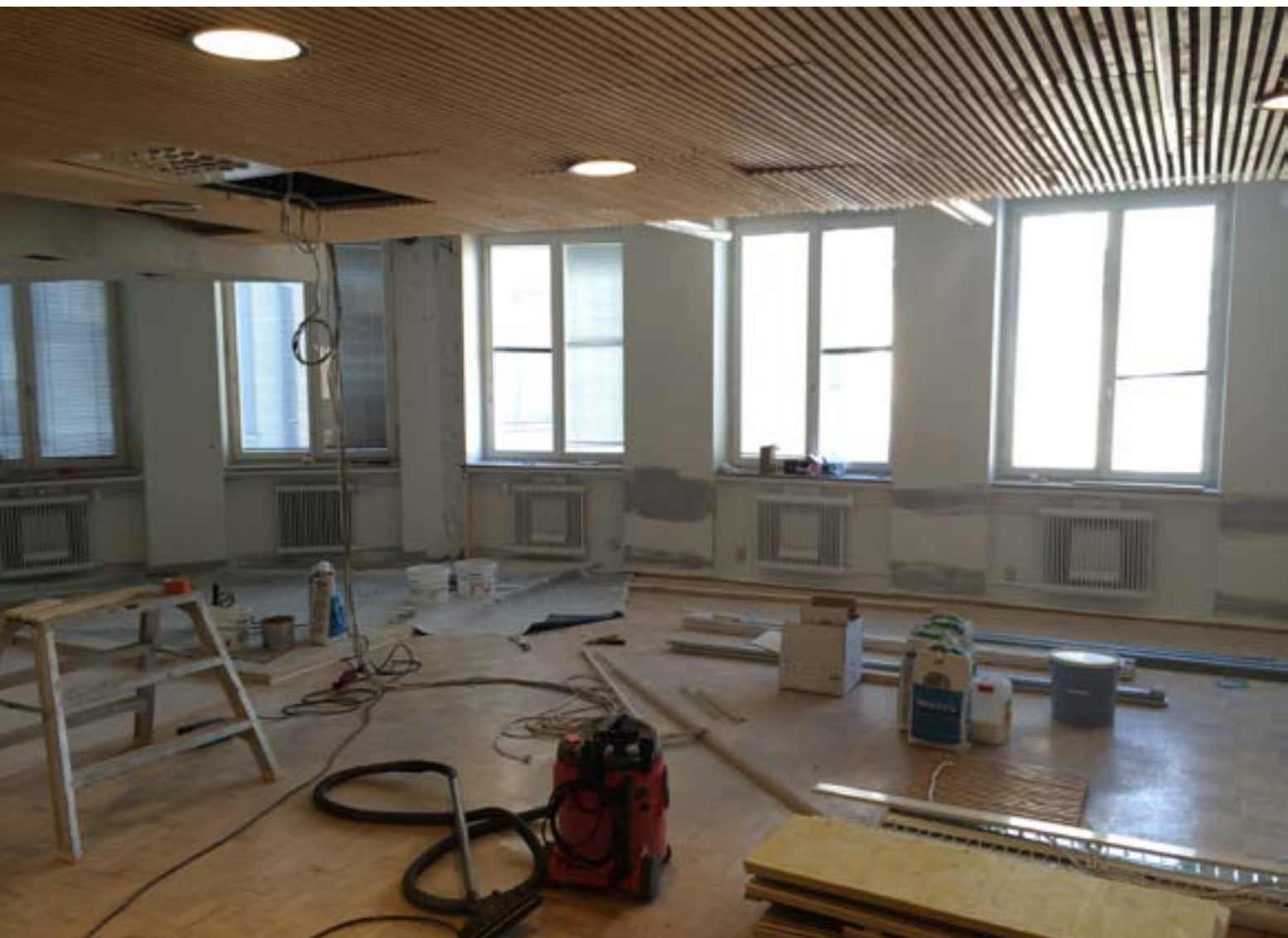
TAKATILASTA PURETTIIN PARI VÄLISEINÄÄ JA LATTIAA JOUDUTTIIN OSIN UUSIMAAN
