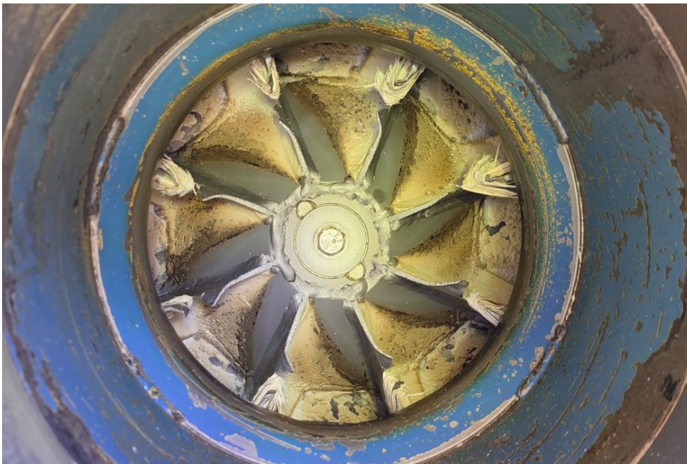
Kuva 7. Siirtolinjan puhaltimen vaurioitunut juoksupyörä
