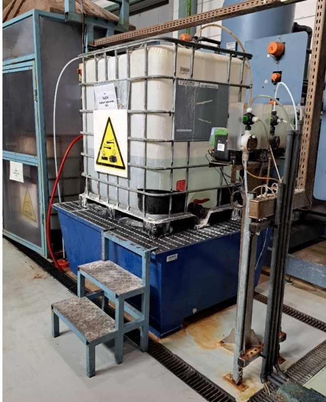
Kuva 8 1200 litran natriumhydroksidikontti jätevesilaitoksella (Viitanen 2024)
