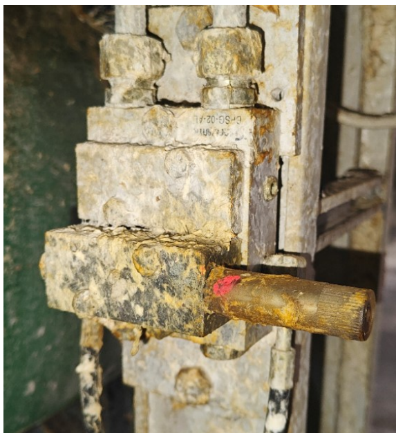
Kuva 7. Annostinryhmässä pohjalaatta ja yksi annostin keskipakopumpun rasvaamiseen
