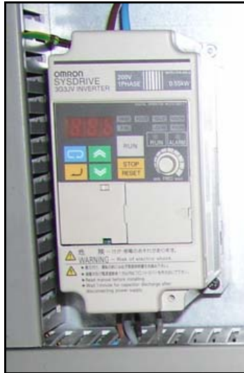
Kuva 3.1 Taajuusmuuttaja radan moottorille
