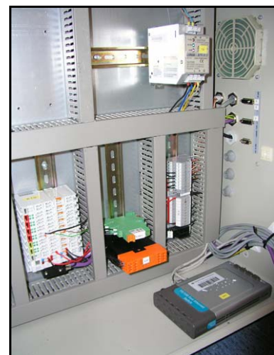
Kuva 2.7 Valmis sähkökaappi vasemmalta päin kuvattuna
