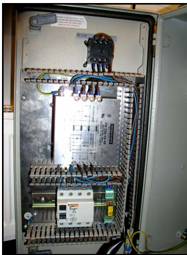
Kuva 2.1 230V:n osien tarkastus
