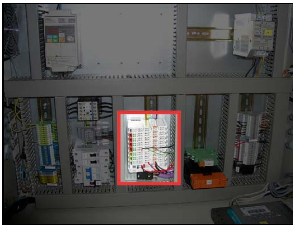
Kuva 3.2 Sähkökaapin I/O, RT0
