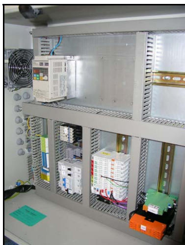
Kuva 2.6 Valmis sähkökaappi oikealta päin kuvattuna
