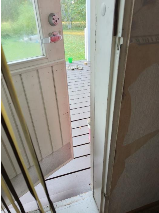
Kuvio 8. Kuntotarkastettavan rakennuksen oven irronnut tiiviste
