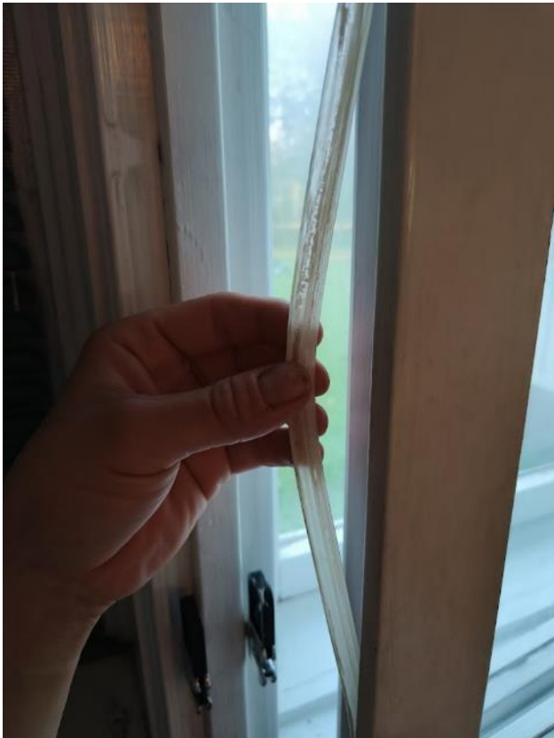
Kuvio 7. Kuntotarkastettavan rakennuksen ikkunan tiiviste irti
