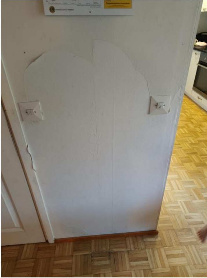
Kuvio 12. Kuntotarkastettavan rakennuksen keittiön rikkiäinen tapetti
