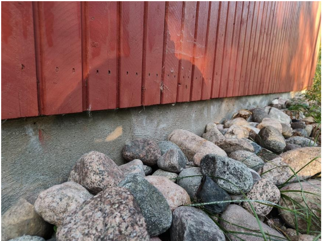
Kuvio 1. Kuntotarkastettavan rakennuksen sokkelin kosteusvauriota
