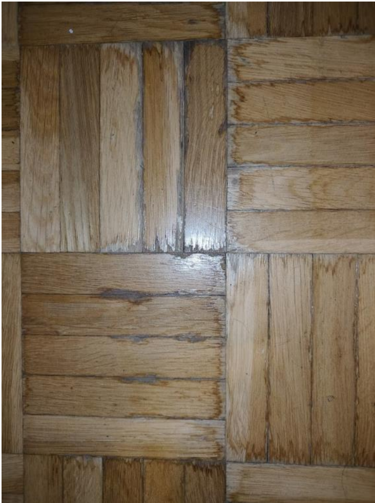
Kuvio 23. Parketin kosteusvaurio, joka ilmeni kuntotutkimuksessa
