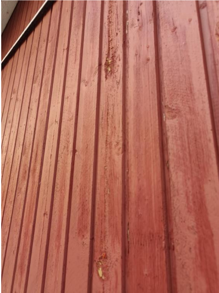
Kuvio 5. Kuntotarkastettavan rakennuksen julkisivun maalivaurio
