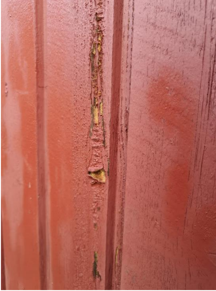
Kuvio 4. Kuntotarkastettavan rakennuksen julkisivun maalivaurio
