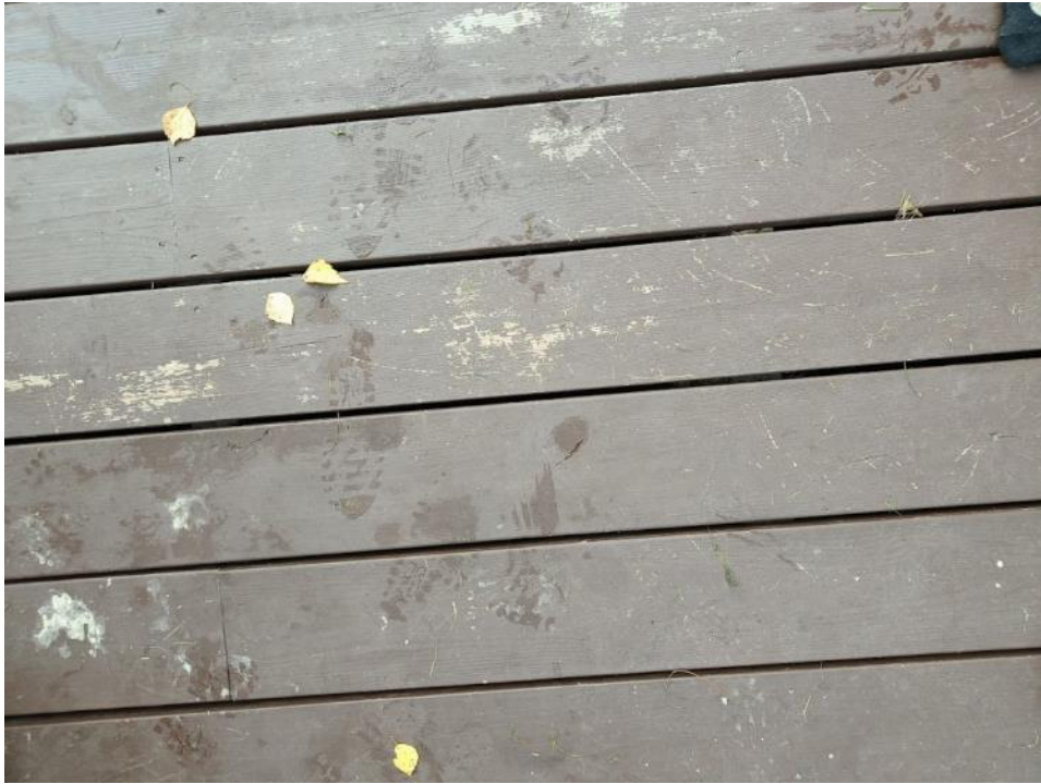
Kuvio 3. Kuntotarkastettavan rakennuksen terassin maalivaurio
