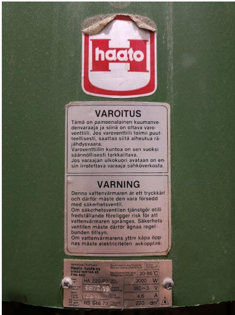
Kuvio 16. Kuntotarkastettavan rakennuksen vesivaraajan tiedot
