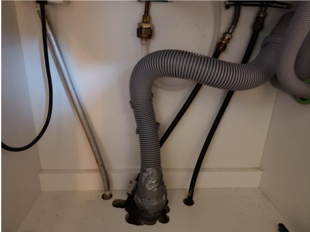
Kuvio 11. Kuntotarkastettavan rakennuksen keittiön allaskaappi ei ole tiivis
