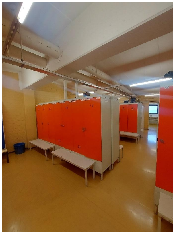
KUVA 2. Pukuhuoneen pinnat ja kalusteet ovat kuluneet ajan saatossa. (Laakso 2024.)
