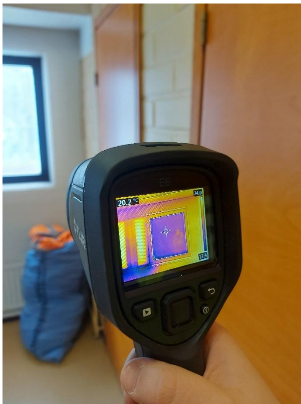
KUVA 14. Ikkunoiden lämpökamerakuvauksessa havaittiin ikkunoiden tiivisteiden vuotaminen. (Laakso 2024.)
