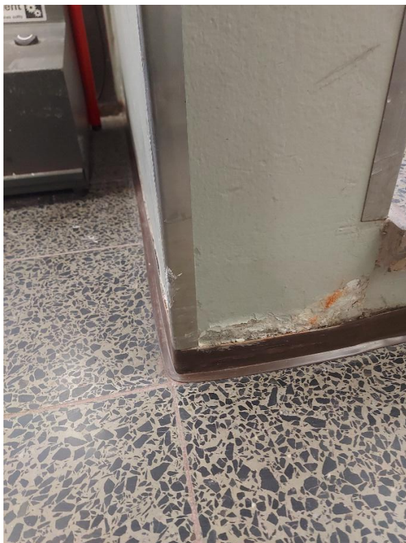
KUVA 10. Aistivaraisia havaintoja kosteusvaurioista. (Laakso 2024.)
