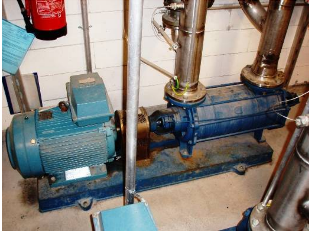
KUVA 12 Sihi TKHA 12303 pumppu suorakytkettynä sähkömoottoriin
