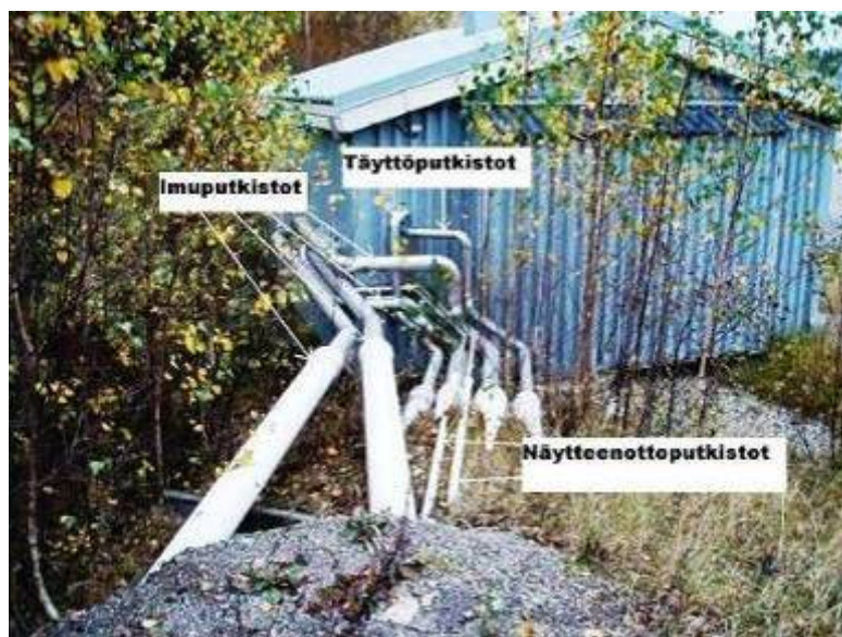
KUVA 10 Maasäiliöiden imu- ja täyttöputkistoja
