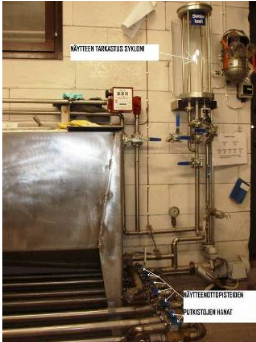
KUVA 5 Pumppaamon suljettu näytteenottojärjestelmä
