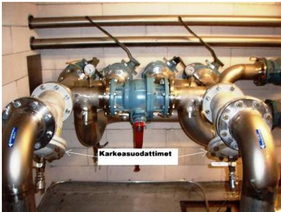
KUVA 11 Pumpuille tulevien imulinjojen karkeasuodattimet
