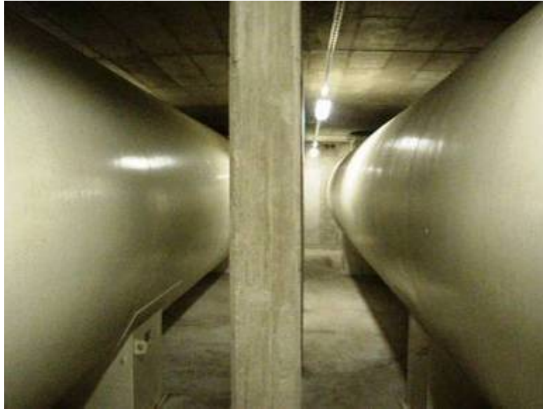
KUVA 9 Maasäiliöt vaatimustenmukaisessa betonisessa suojakammiossa
