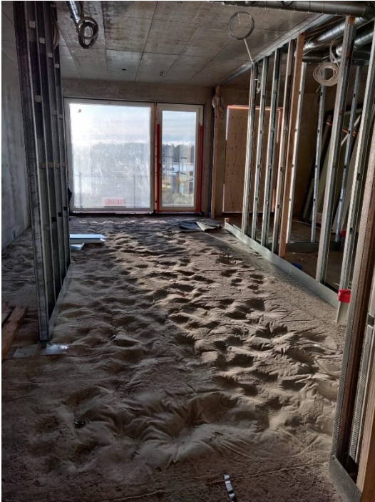
Kuva 15 Epätasainen lattiarakenne ennen pinnan viimeistelyä (YIT, n.d.).
