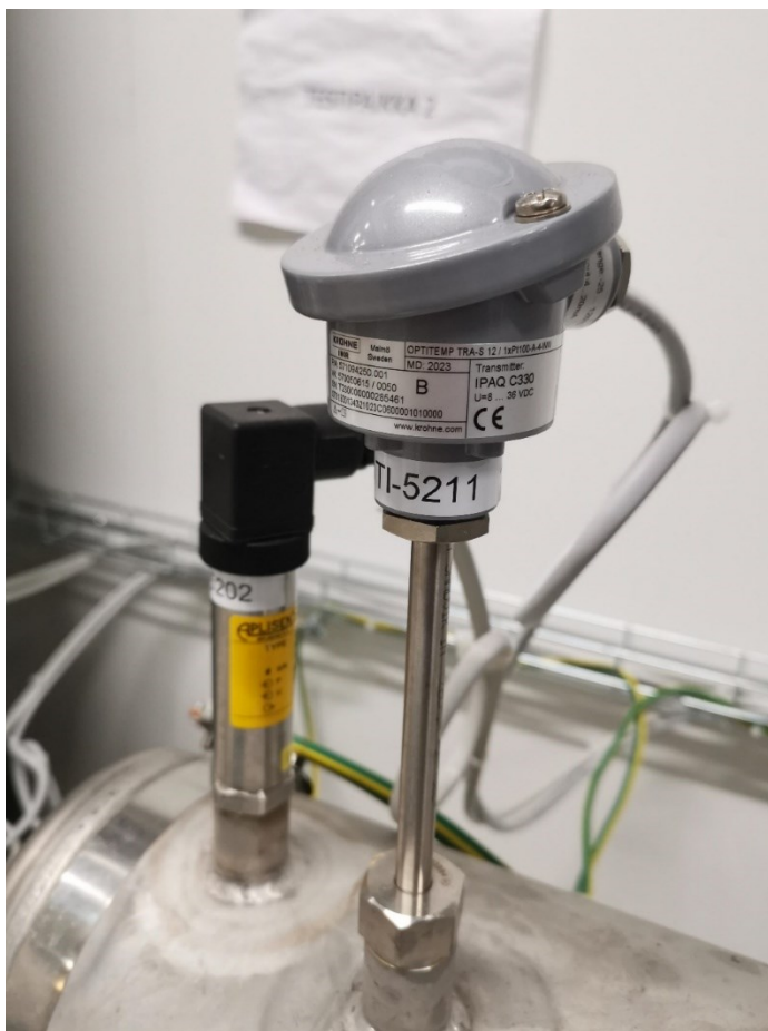
KUVA 15. Taustalla paineanturi Aplisens ja edessä lämpötila-anturi Krohne Inor. (Pekkalin, 2024)
