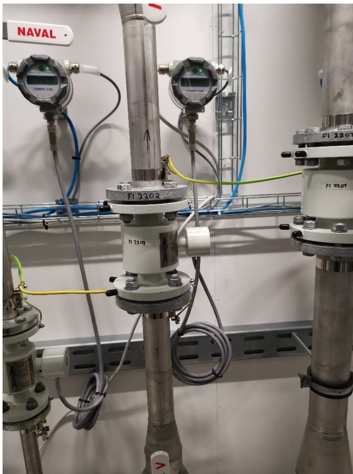
KUVA 16. Comac Calin DN50-virtausmittari ja -lähetin asennettuna mittauslinjaan. (Pekkalin, 2024)
