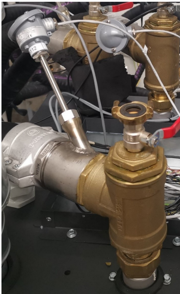
KUVA 14. Lämpötilaeroa mittaava anturi lämpöpumpun päällä 45° -kulmassa virtaussuuntaan. (Pekkalin, 2024)
