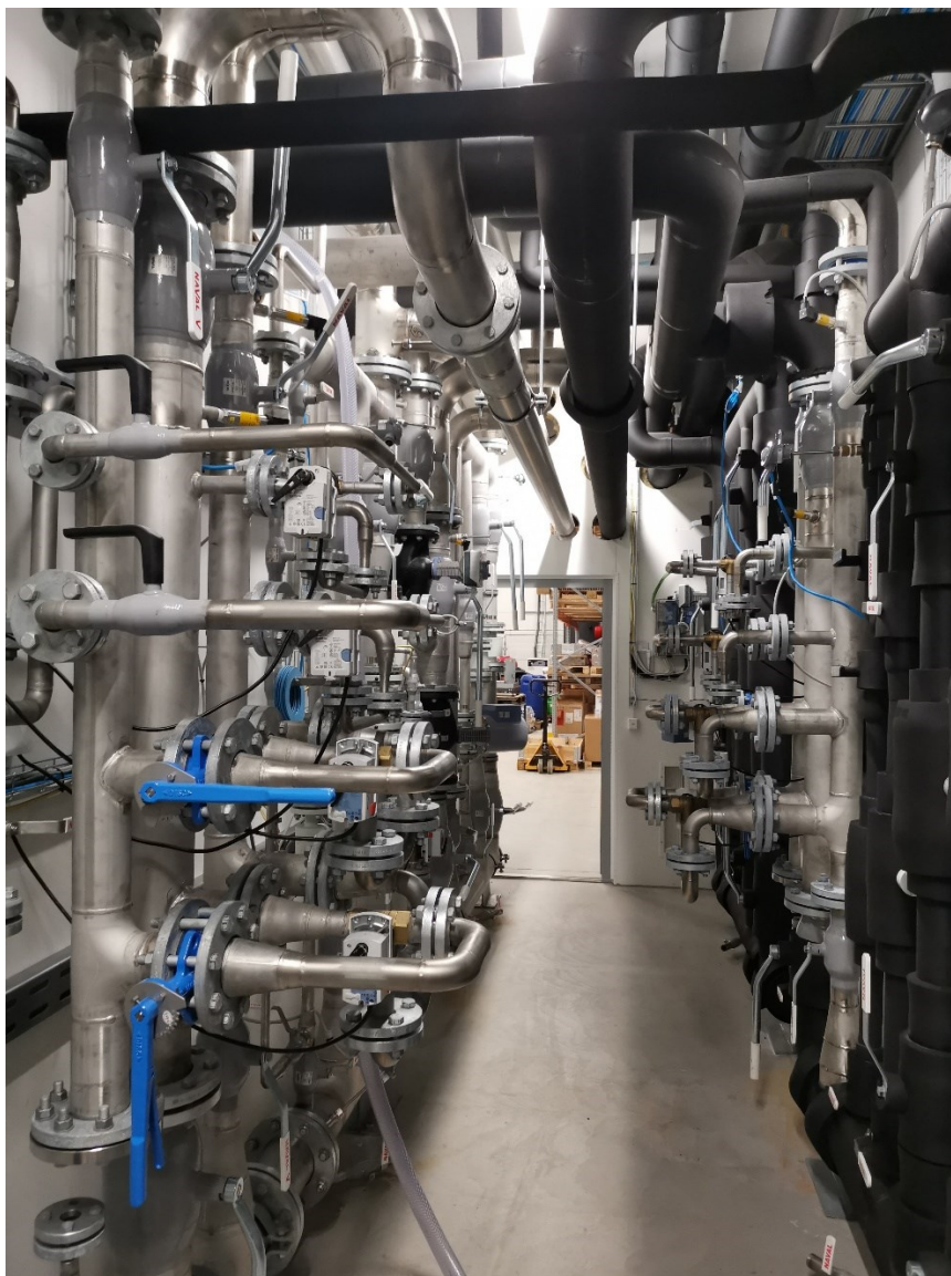
KUVA 7. Virtausmittarihuone, etualalla neljä erikokoista sekoitusventtiiliä ja katossa testipaikoilta 2 ja 3 palaavat putkistot. (Pekkalin, 2024)
