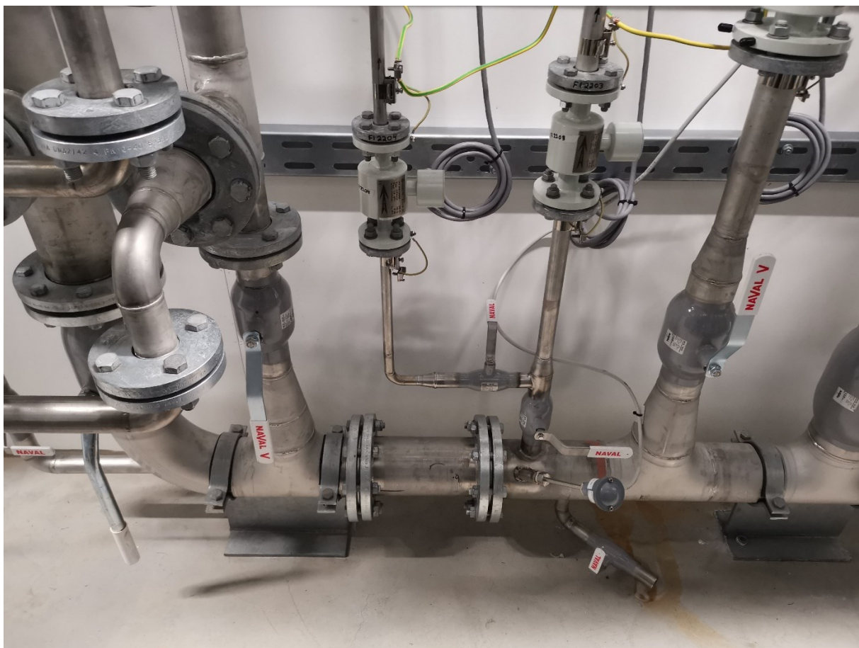
KUVA 11. Sekoittaja putkistoon asennettuna ja lämpötilamittaus siirrettynä heti sen jälkeen. Kuvassa näkyy myös kaksi pienintä lauhdelinjan virtausmittaria 6–40 kW lämpöteholle. (Pekkalin, 2024)
