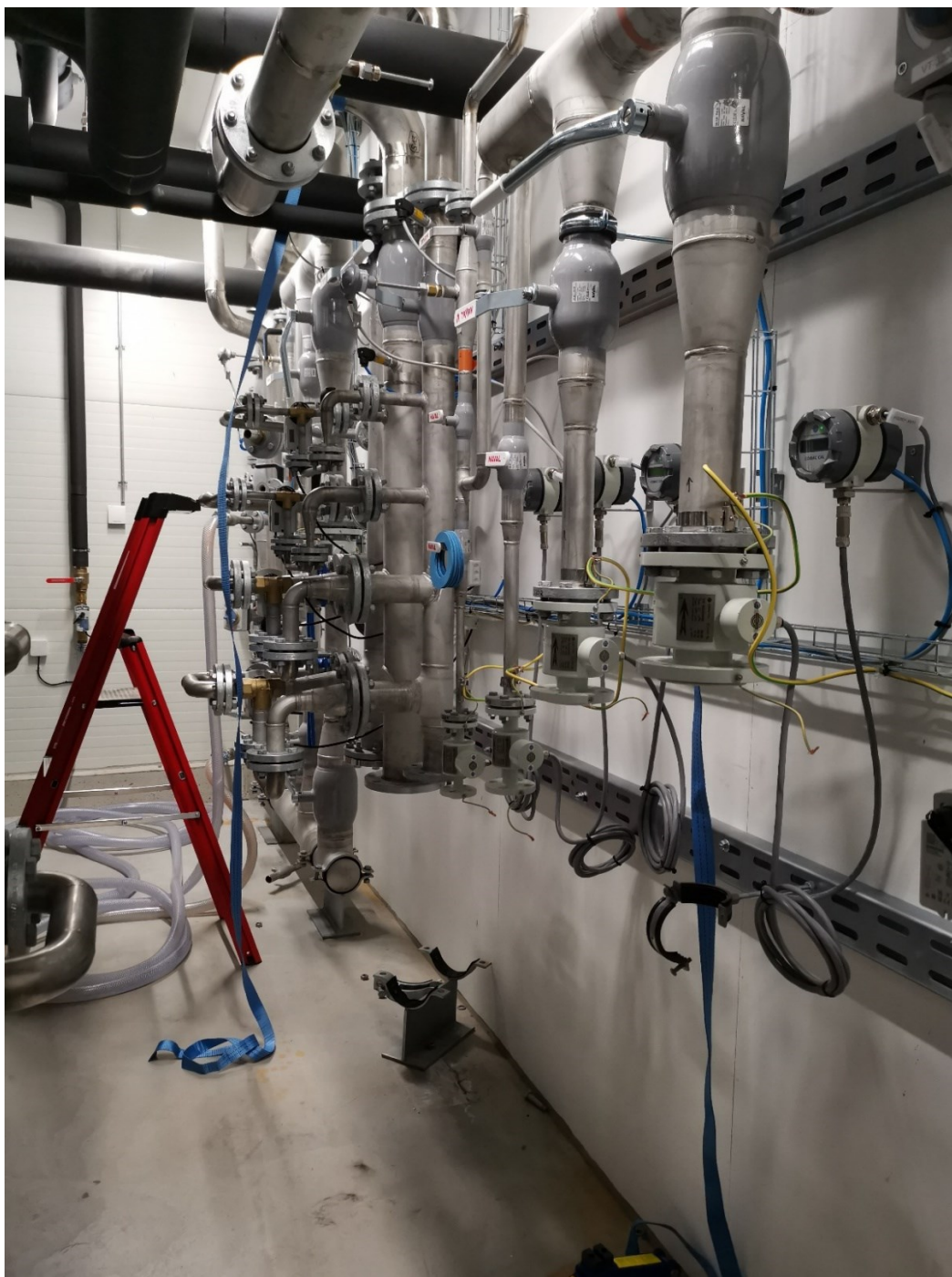
KUVA 13. Lauhemittaristo alaputkisto purettuna. Kuvassa näkyvät virtausmittarit ja 3-tie säätöventtiiliryhmät. (Pekkalin, 2024)
