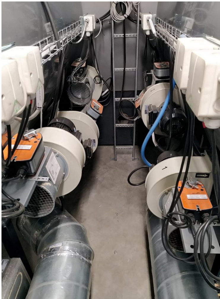
Kuva 16. Puhallimet ja niiden säätöpellit (Remes 2023)
