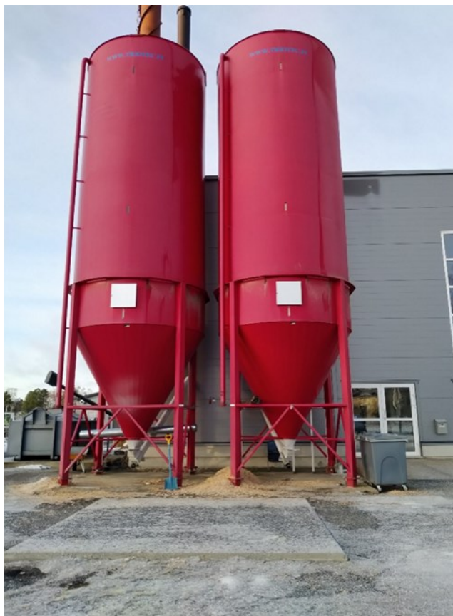
Kuva 14. Nykyiset pellettisiilot sekä alusta kolmannelle siilolle. Taustalla jätetuhkasäiliö. (Remes 2023)
