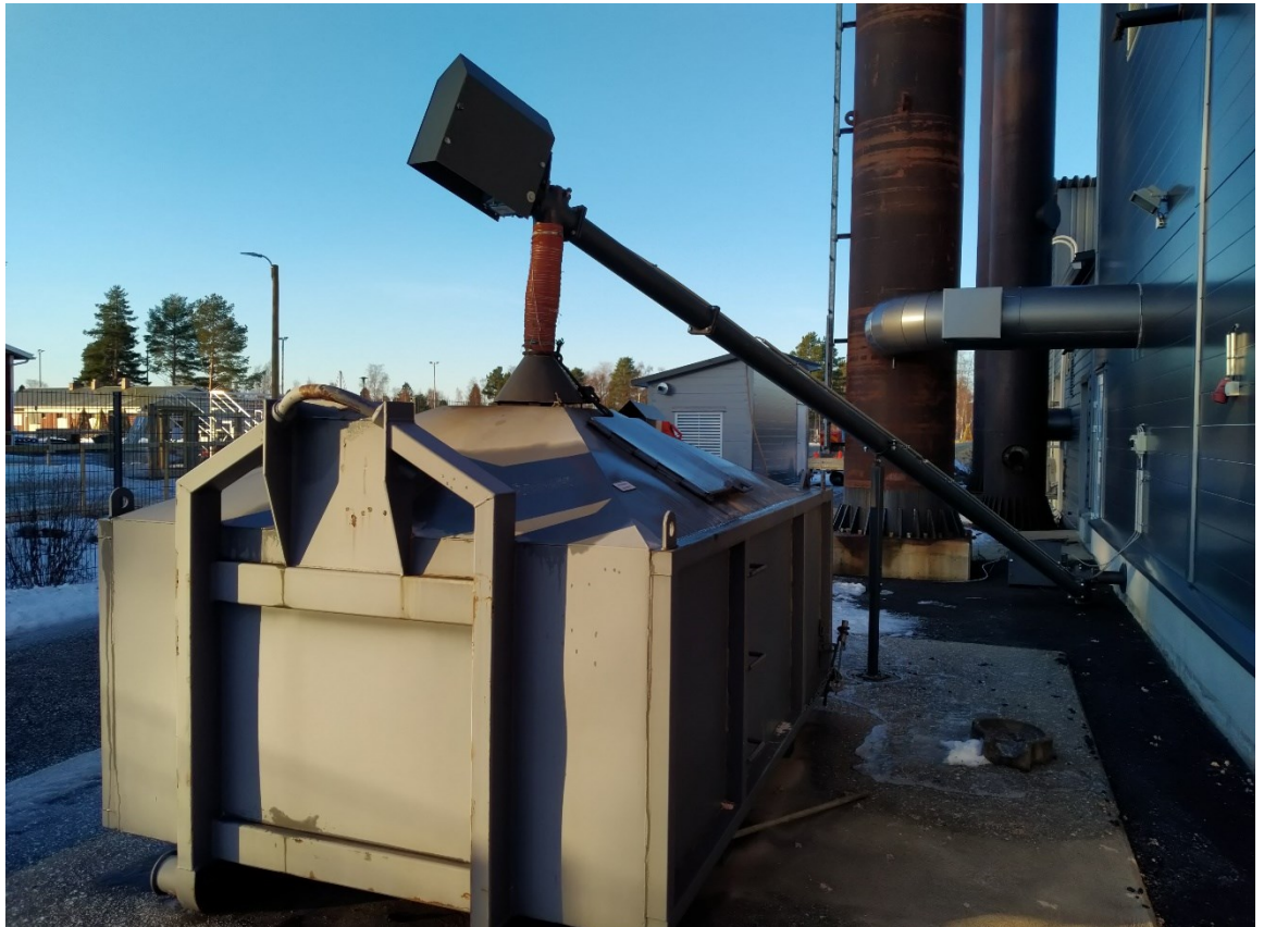
Kuva 18. Jätetuhkasäiliö tuotantotilan ulkopuolella (Remes 2023)
