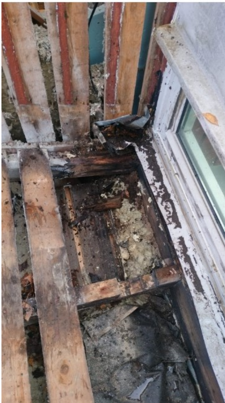
Kuva 9. Kosteusvaurio rakenteessa (Korhonen 2024)
