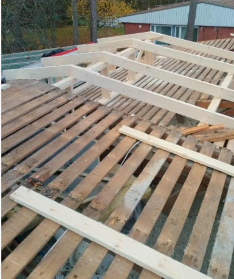
Kuva 10. Kattolapteen muutos (Korhonen 2024)
