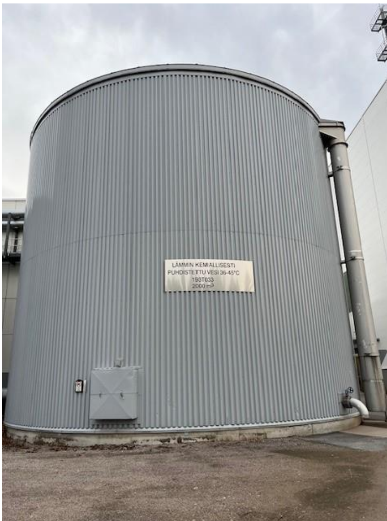
Kuvio 14. Lämpimän kemiallisesti puhdistetun veden säiliö (VLK).
