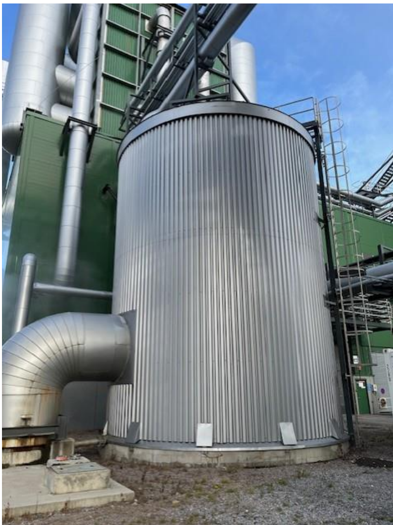
Kuvio 7. Haihuttamon lämminvesisäiliö ja taustalla yläosassa pintalauhdutin.
