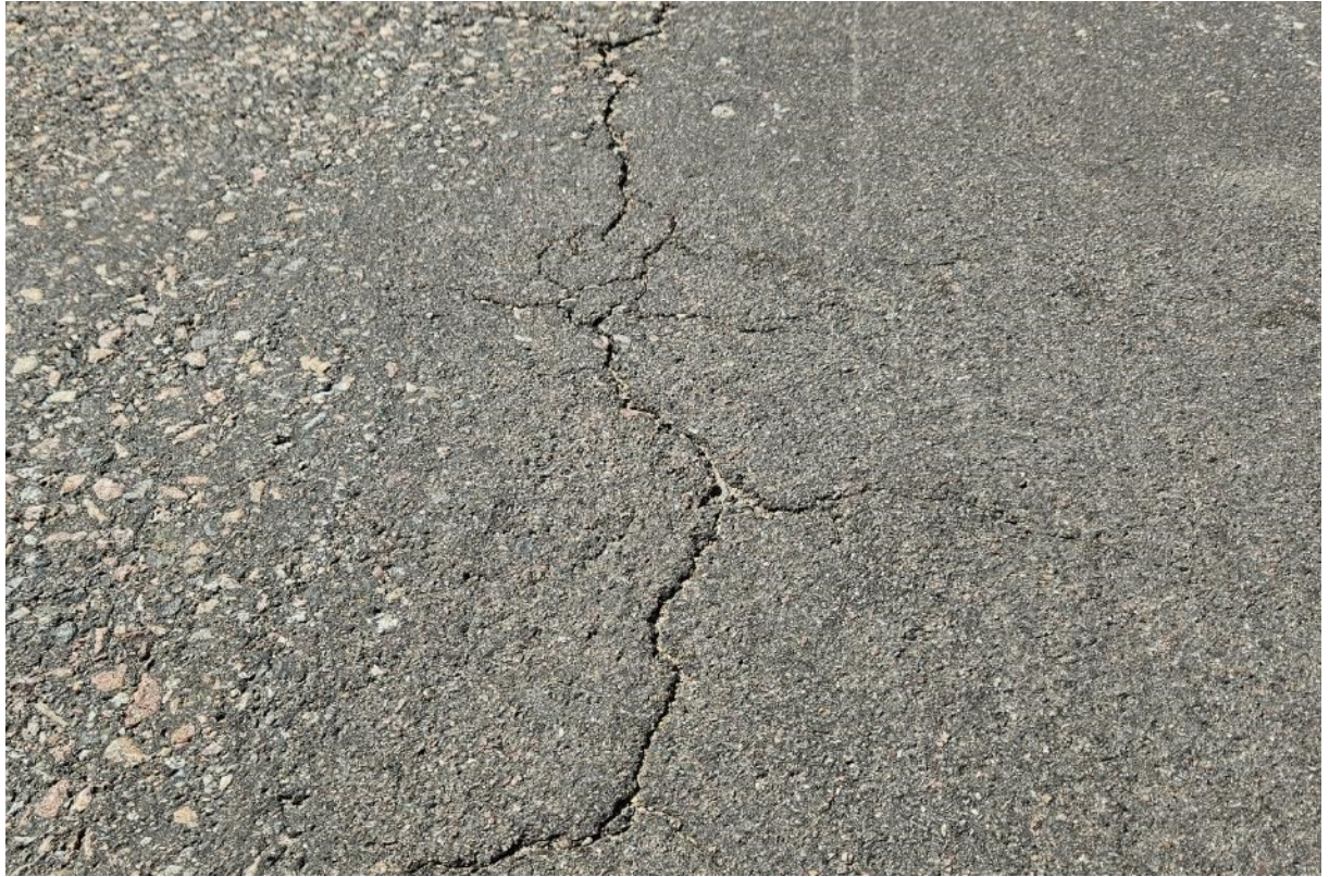
Kuva 11. Verkkohalkeama, alkavaa purkaamaa (Finavia, n.d.).
