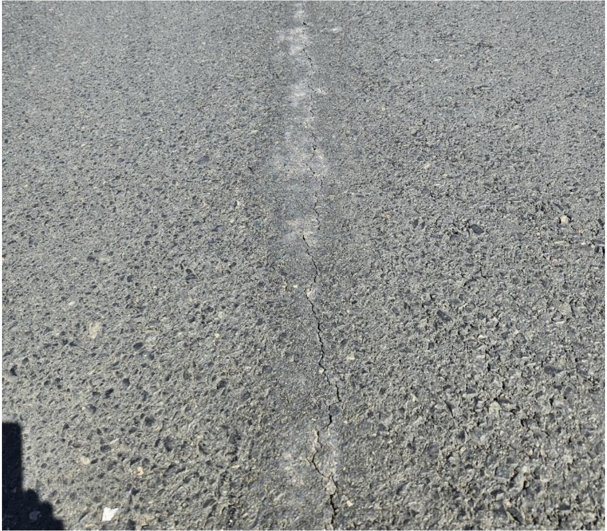
Kuva 20. Viivamainen kemikaalisäostuma saumahalkeamassa (Finavia, n.d.).
