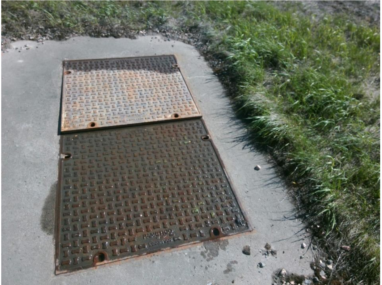
Kuva 23. Maasähkökaivon kansi, ei sulkeudu (Finavia, n.d.).
