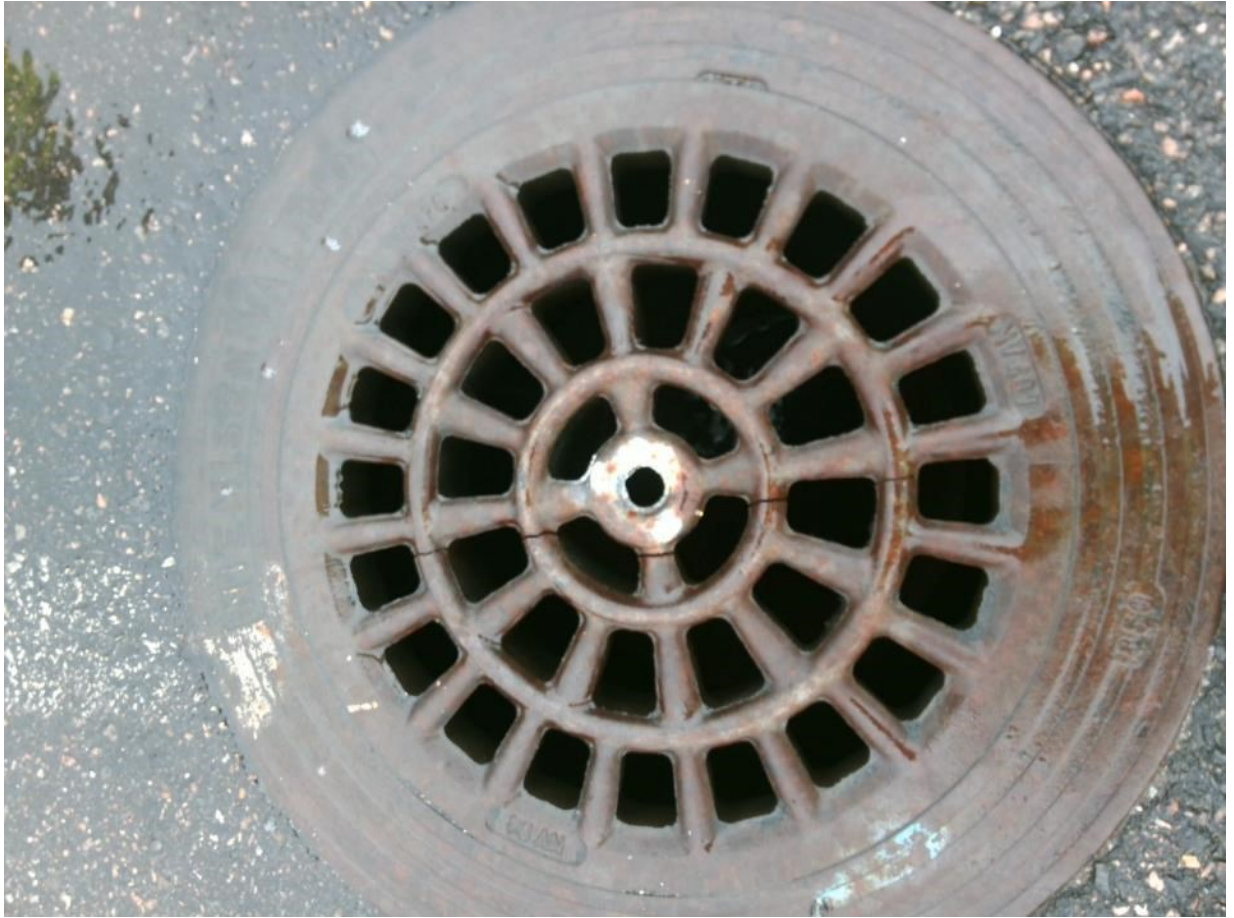
Kuva 24. Sadevesikaivon ritiläkansi, haljennut (Finavia, n.d.).
