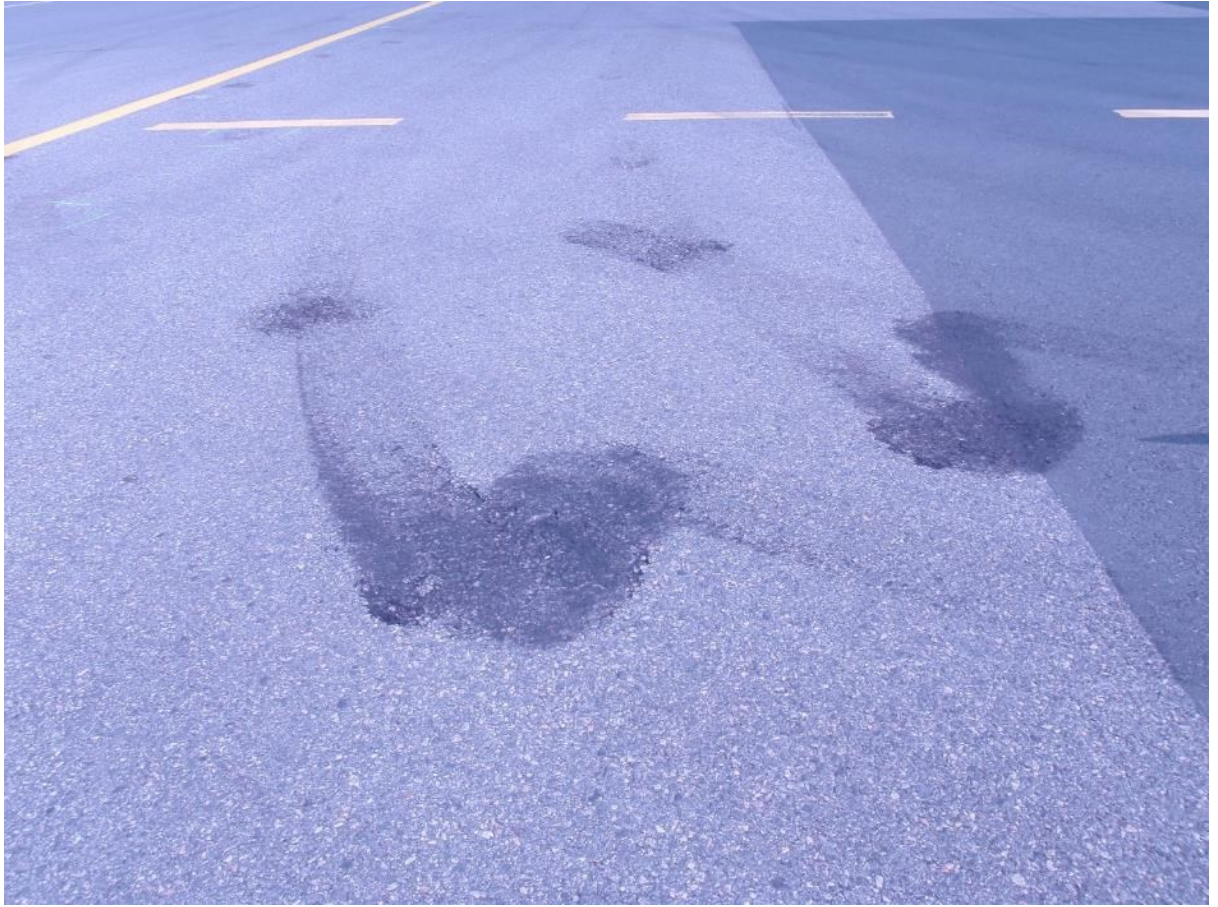
Kuva 13. Hiertymävaurio (Finavia, n.d.).
