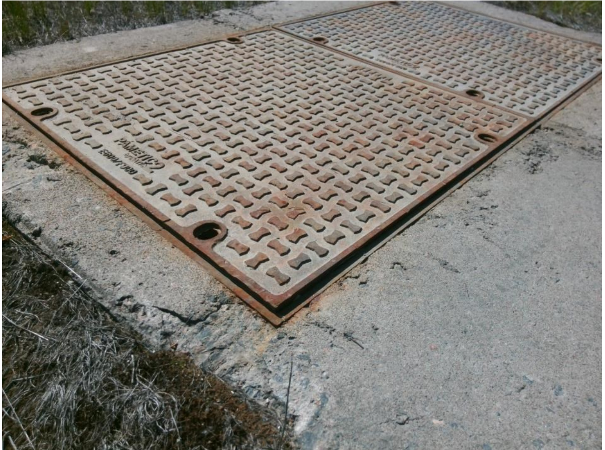
Kuva 22. Maasähkökaivon kansi (Finavia, n.d.).
