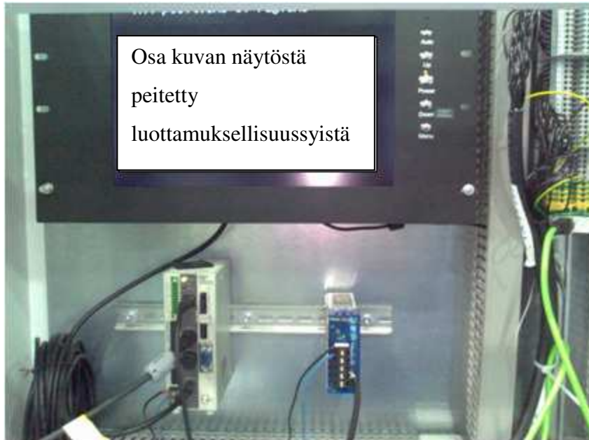
Kuva 18 Konenäkölaitteisto asennettuna kaappiin.
