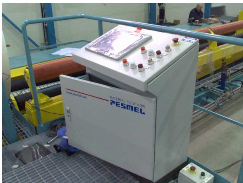
Kuva 17 Yksi pakkauslinjan ohjauskaapeista, johon konenäkölaitteisto on sijoitettu.
