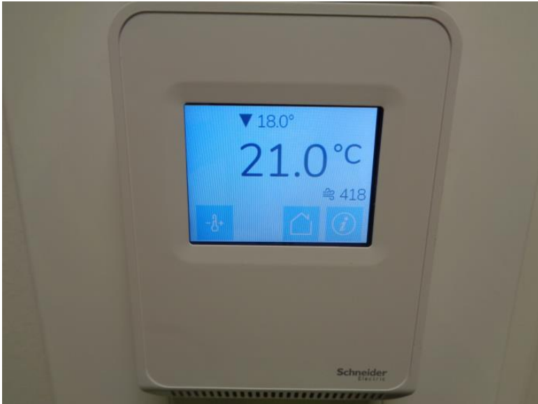
KUVA 17. Huonesäätimen näyttö indikoi tilan jäähtymistä, tilan CO2-arvon, ja uuden asetetun tavoitelämpötilan huoneelle
