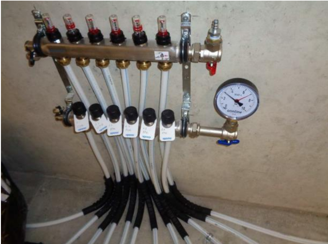
KUVA 10. Lattialämmityksen jakotukissa piirien pituudet ja positiomerkinnot sekä piireissä koepaine
