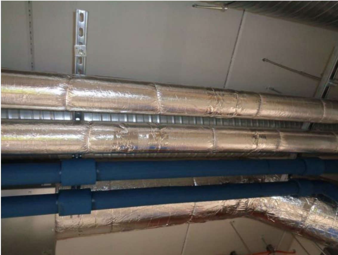
KUVA 7. Lämmitys- ja jäähdytysjohtojen eristepinnat ehjät ja kannakkeet eristetty.
