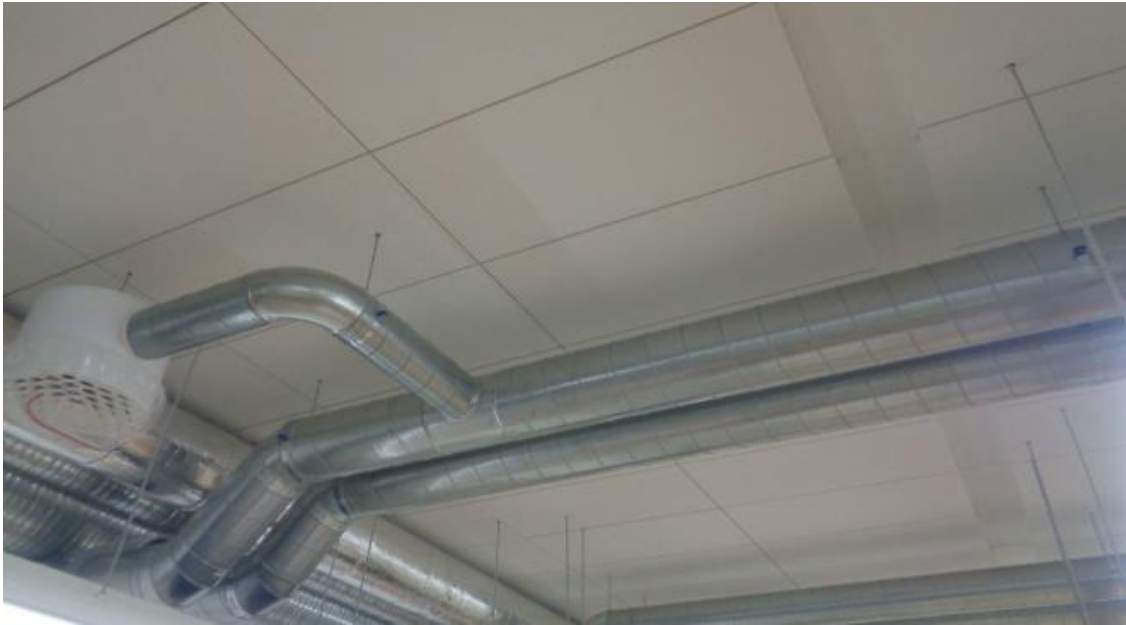
KUVA 9. Ilmanvaihtokanava ja päätelaitteet on kannakoitu asianmukaisesti.
