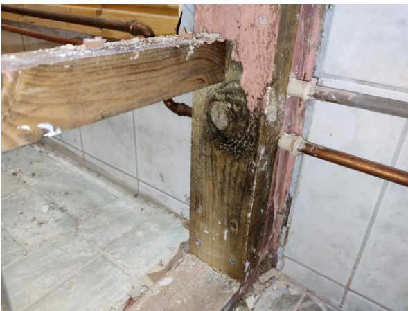
KUVA 11. Kosteusvauriota väliseinän rakenteissa
