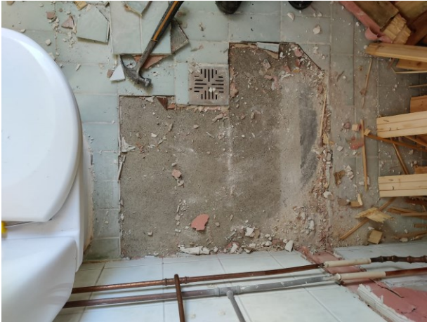
KUVA 13. Vuotokohta paljastui laattoja purkaessa
