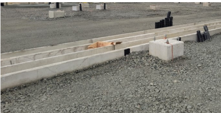
Kuva 5. Kaapelikanaalit asennettuna. (Nätti 2023)
