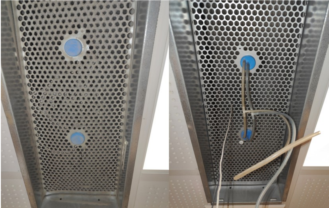
KUVA 3. Merkittävästi likaantunut kytkentälaatikon etulevy ennen ja jälkeen puhdistuksen
