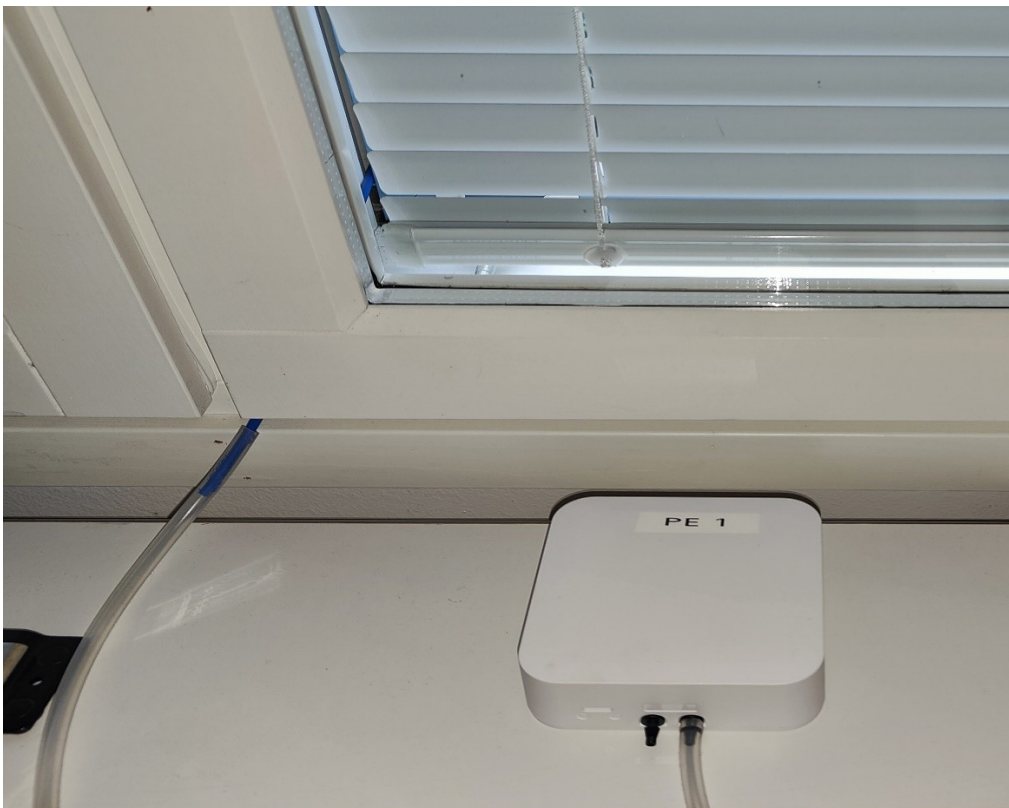
KUVA 5. Jatkuvassa seurantamittauksessa käytettävä paine-erologgeri, joka mit-taa paine-eroa rakennuksen ulkovaipan yli
