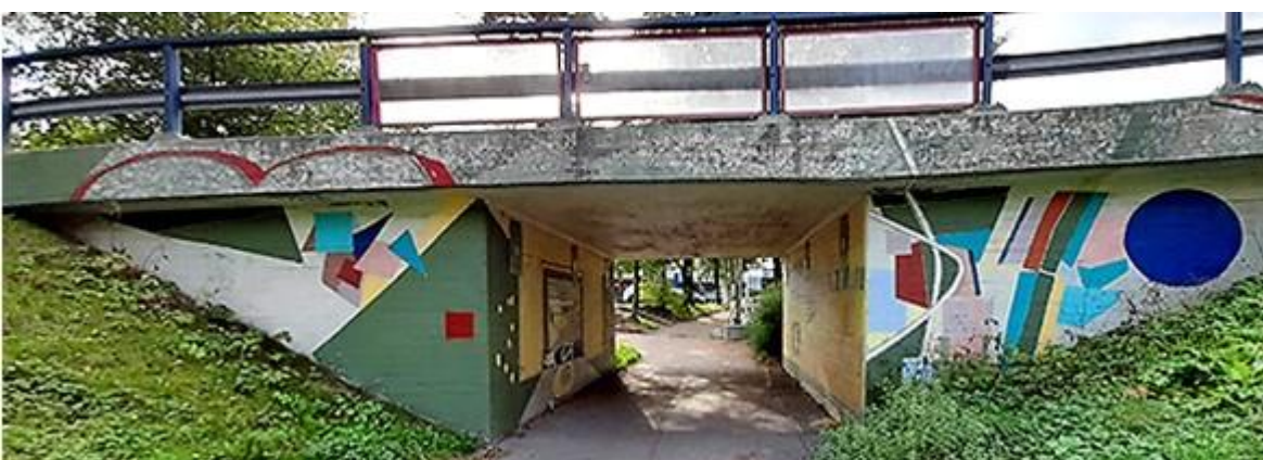
Kuva 11. Yllä näkymä ostarille päin v. 2023. Yläpalkeille ei ole tehty mitään liki 10 vuoteen. Palkkeihin ei kannata takaa tulevan kosteuden vuoksi maalata yhtenäistä maalipintaa, mutta ehkä niitä voisi raikastaa korostamalla kevyesti joko vauriokohtia tai niiden väliin jääviä muotoja.
