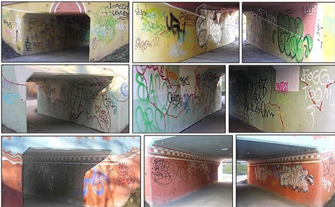
Kooste 18. Kevät 2015. Kotipesä | Noppa | Minos. Tilanne ennen pintakäsittelytuotteen vaihtoa. Pintana ohutrappaus eli slammi. Tunnelleita oli ylläpidetty vuosia vain puhdistamalla.
