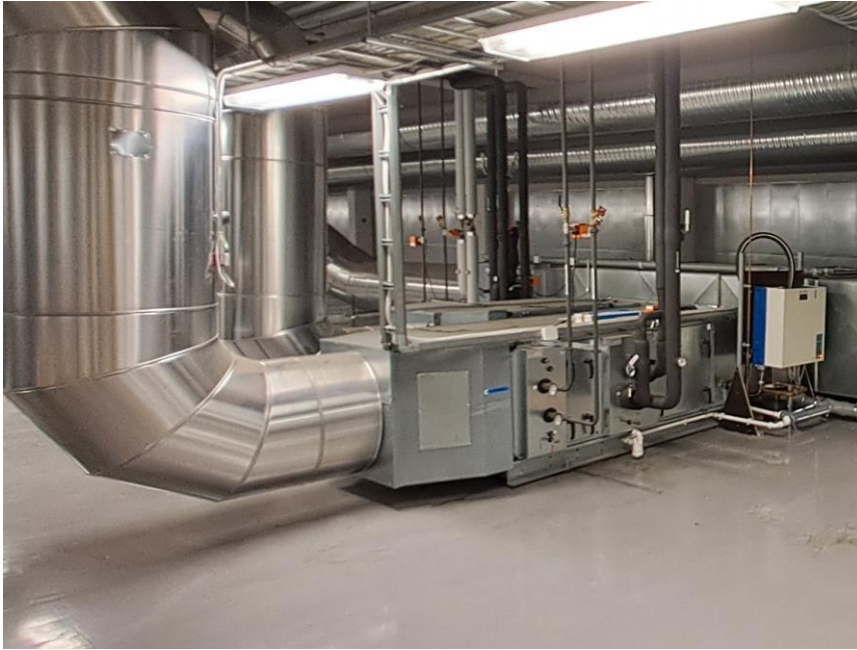
KUVA 2. TK1 tulokanavan jälkisäädöt
