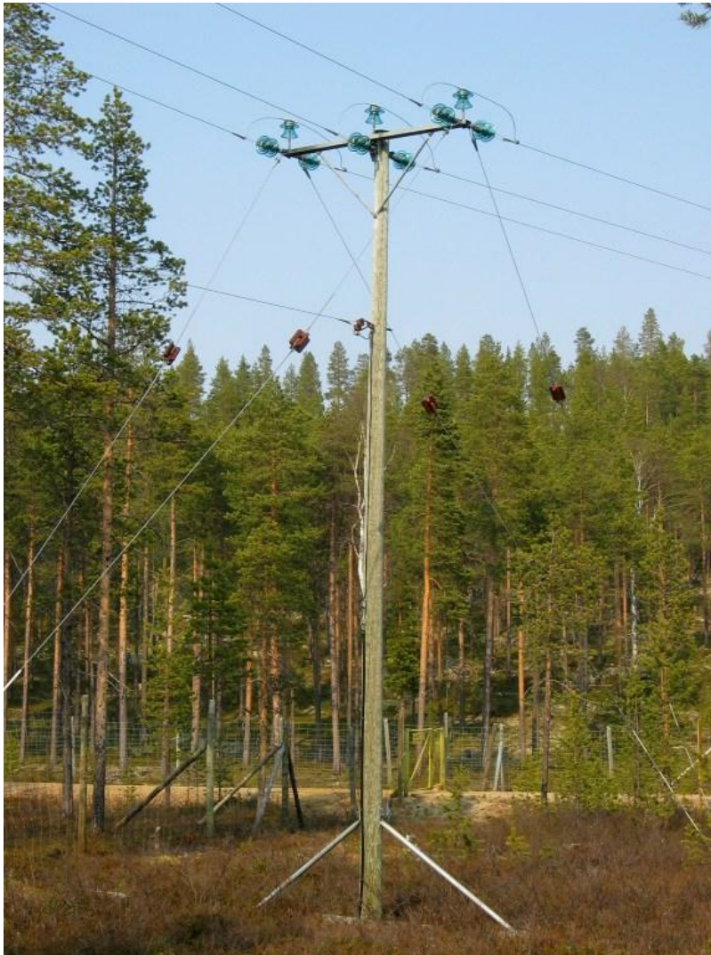
Kuva 4. 20 kV:n kirstyspylväs on tuettu neljällä haruksella [16.]
