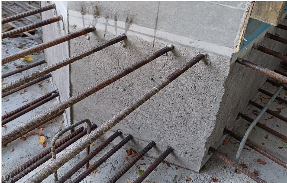
Kuva 16. Pesty työsauma, josta poistettu sementtiliima.
