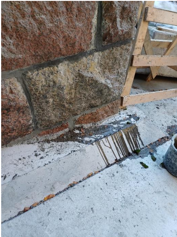
Kuva 28. Epätiivis saumakohta, josta injektointiepoksia valui pois.
