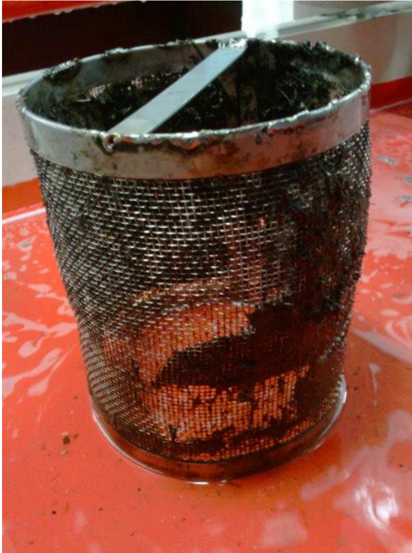
Kuva 10. Likainen lämmönvaihtimen suodatin. (Olli-Ville Laine 2012)
