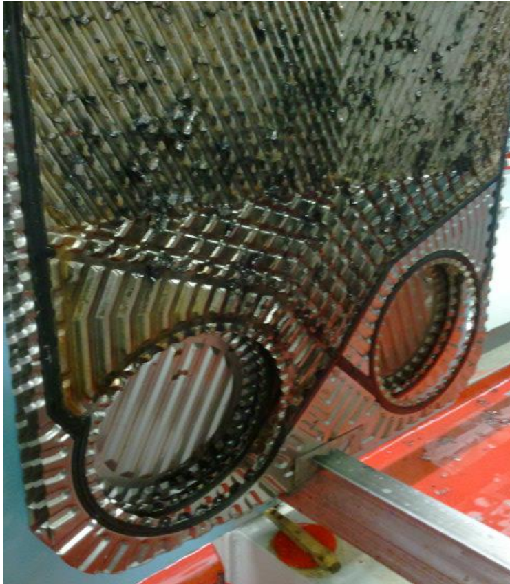
Kuva 6. Lämmönvaihtimen merivesipuolen levy, johon on kertynyt kerrostumaa. (Olli-Ville Laine 2012)
