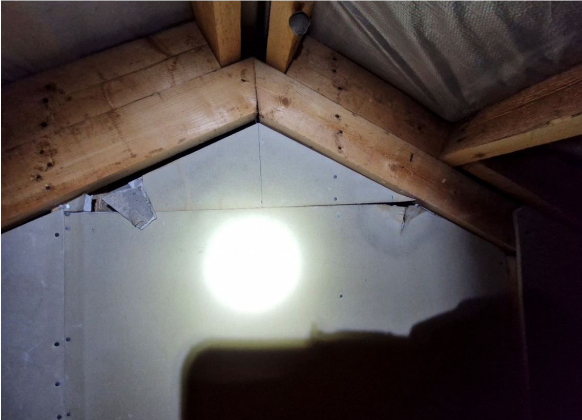
KUVA 9. Peruskorjattavan kohteen palokatkoissa puutteita
