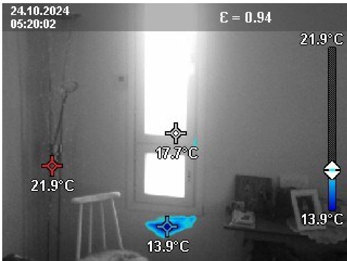
KUVA 16. Lämpökamerakuva sisätarkastuksien yhteydessä
