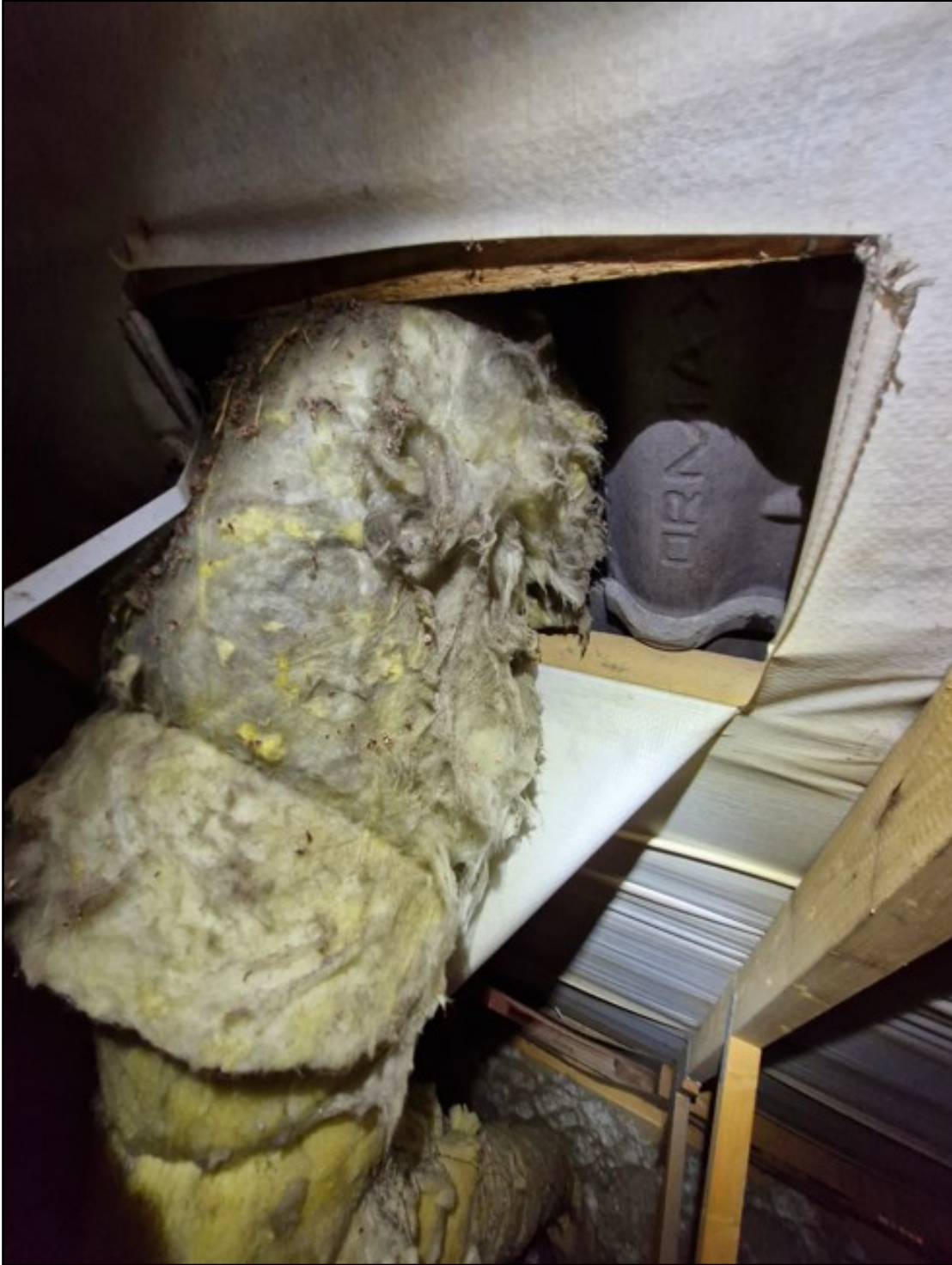
KUVA 5. Kohteen läpivienneissä huomattavia puutteita
