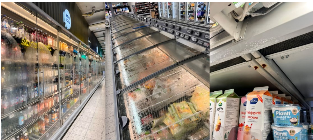
Kuva 11. KSM Postitalon kondenssiongelma (Länsiluoto 2024).
