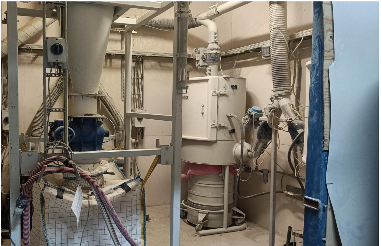
KUVA 4. Poraosaston pölynpoistohuone, jossa esiintyvät tilaluokat 20,21 ja 22
