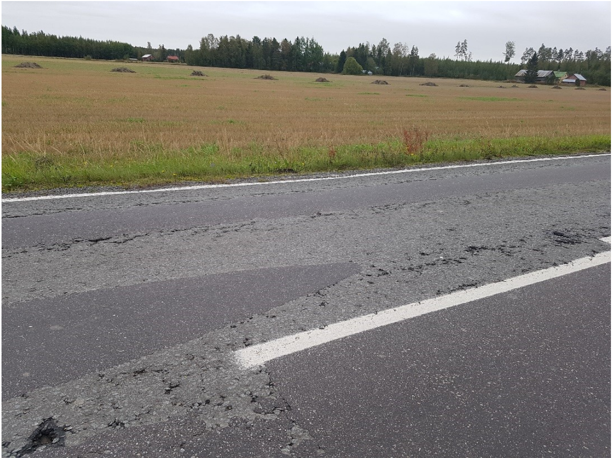
Kuva 7. Tienpäällysteessä esiintyvää purkaumaa.
