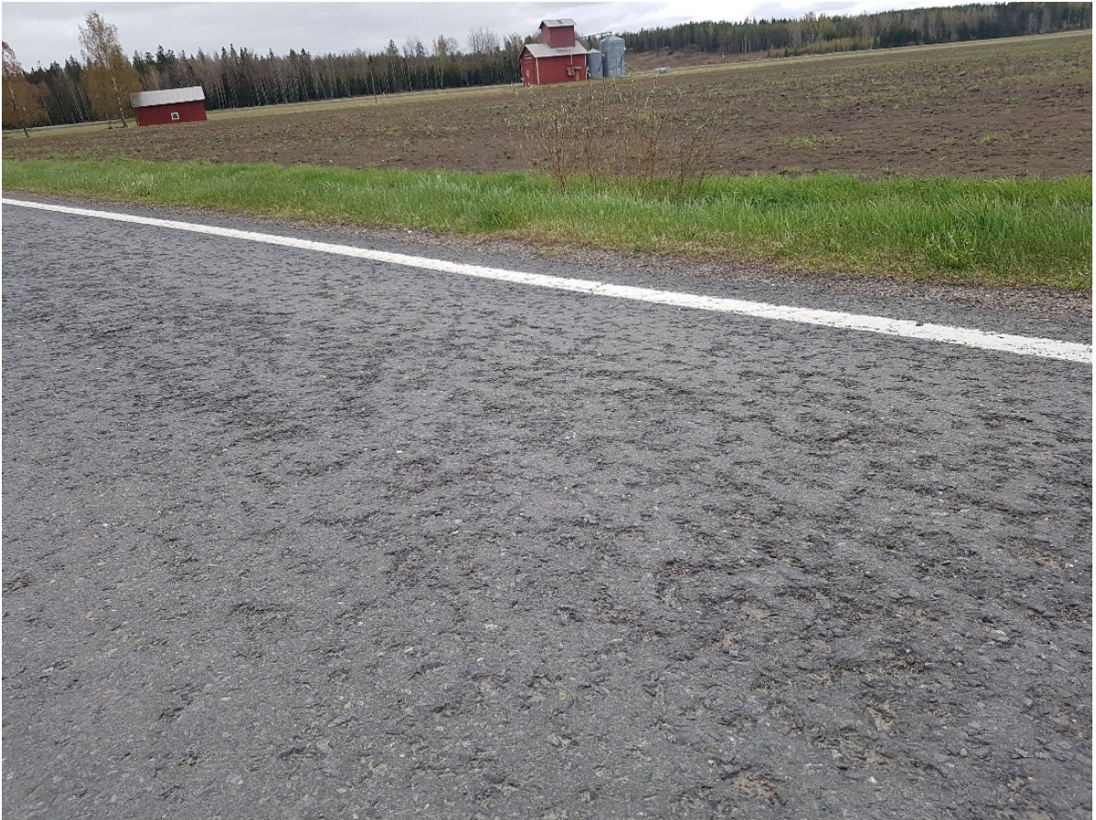
Kuva 8. Purkaumaa, jossa kiviaineksen irtoaminen selkeästi havaittavissa.
