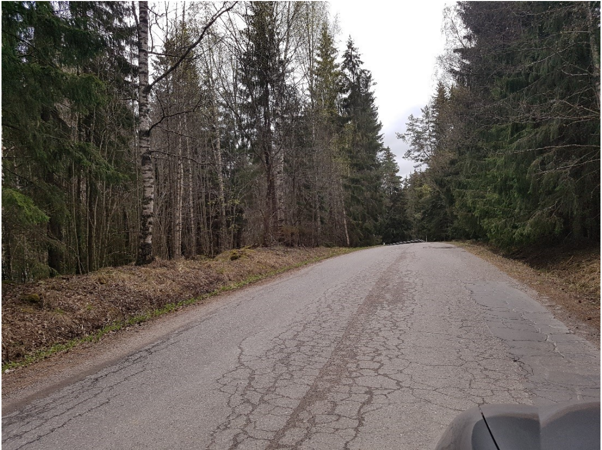
Kuva 5. Laaja verkkohalkeama tiellä.
