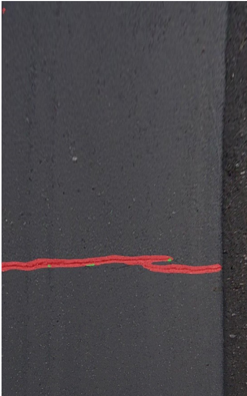
Kuva 18. Konenäön tunnistama poikittaishalkeama tienpäällysteessä. (Destia 2020)
