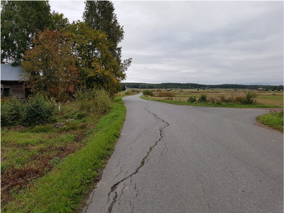
Kuva 2. Vinottain kulkeva pituushalkeama.
