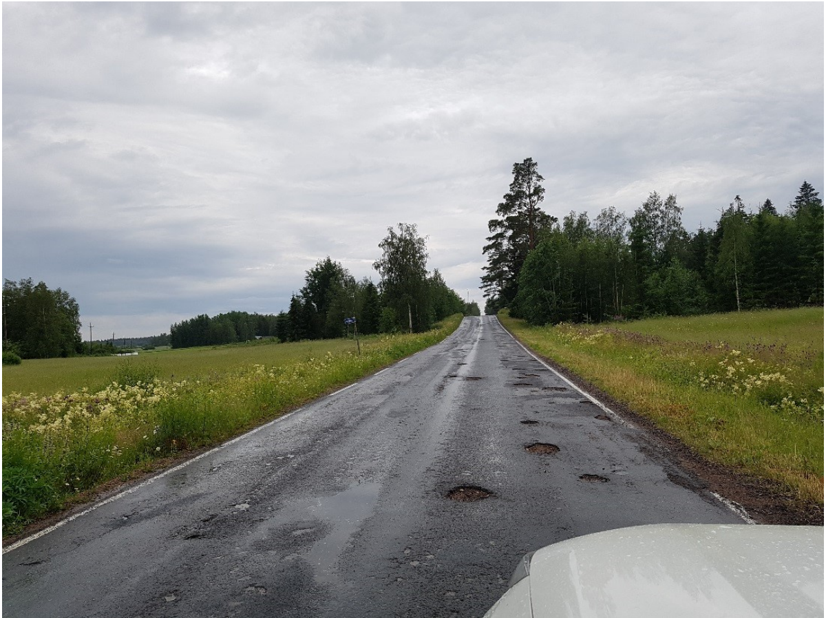
Kuva 9. Tienpäällysteessä olevia reikiä.
