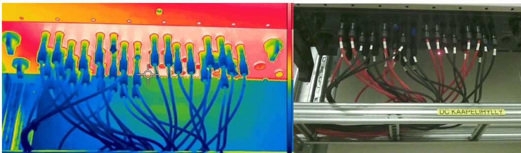
Kuva 20. Invertteri, jossa liitokset ovat kunnossa.
