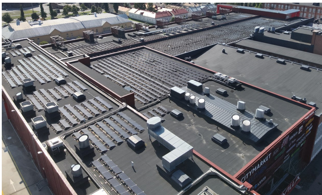
Kuva 1. Puuvillan katto on hyödynnetty tehokkaasti aurinkoenergian tuotantoon.
